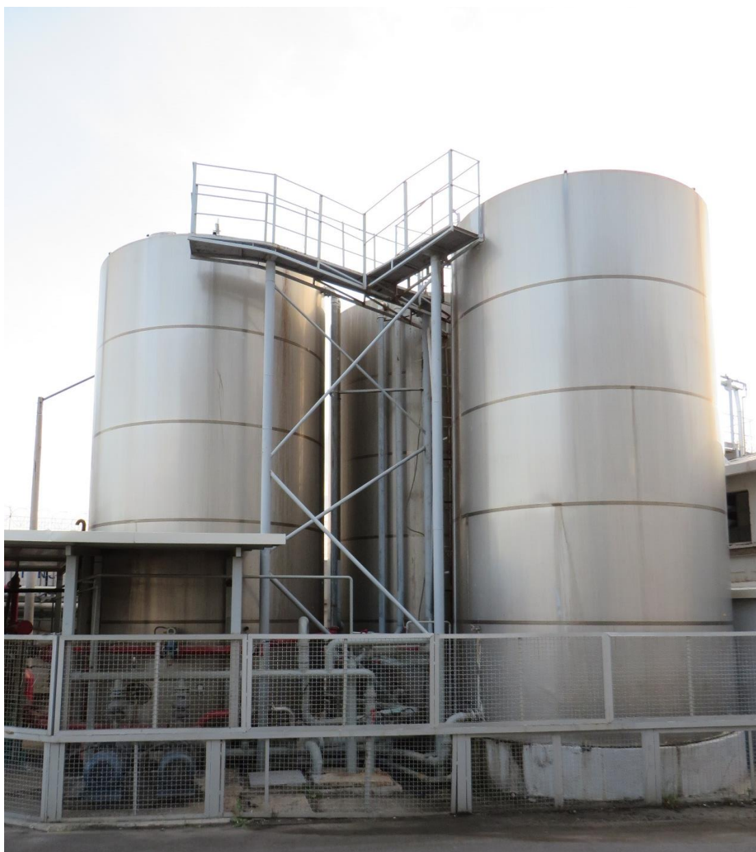
Φωτογραφία 3.2.3.1 Σιλό αποθήκευσης νερού γεωτρήσεως
