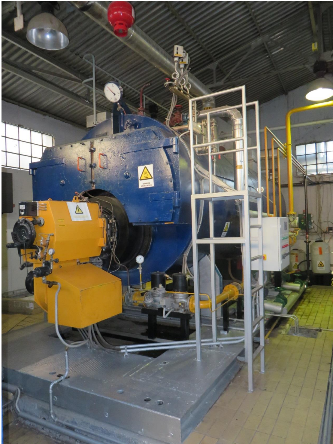
Φωτογραφία 3.2.2.3 Καζάνι παραγωγής υπέρθερμου ατμού Κούπα
