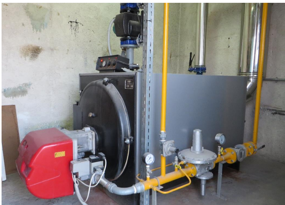
Φωτογραφία 3.2.2.2 Boiler θερμού νερού θέρμανσης γραφείων διοίκησης
