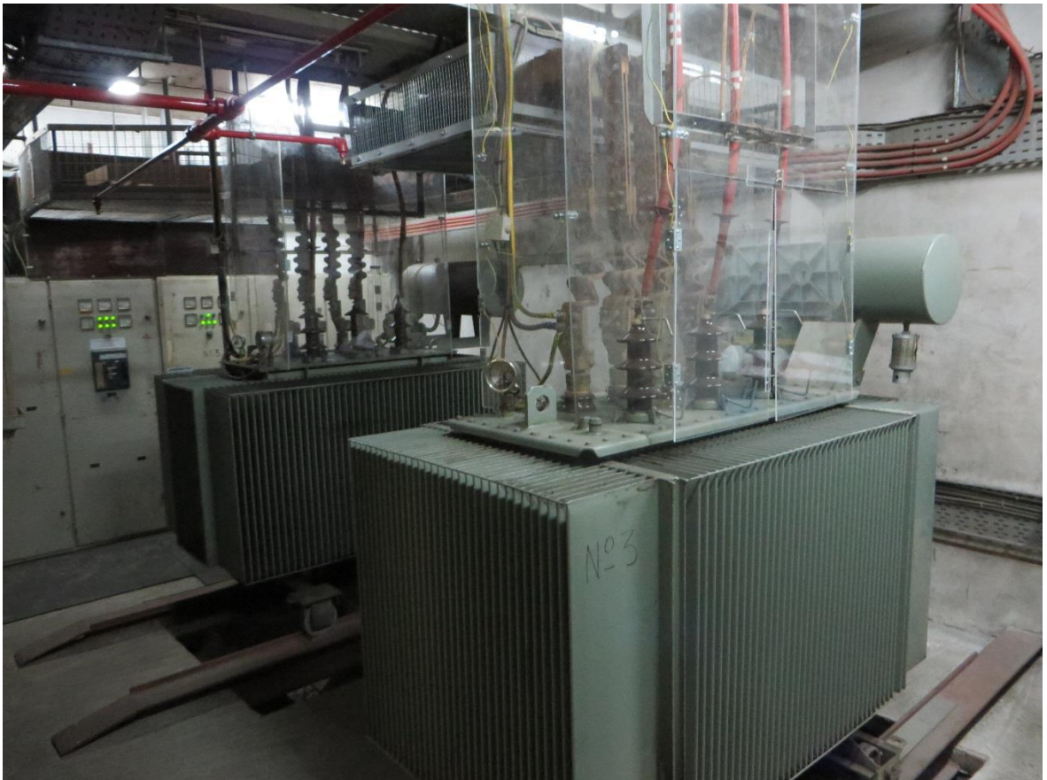
Φωτογραφία 3.2.1.1 Μετασχηματιστές Ισχύος #2 και #3
