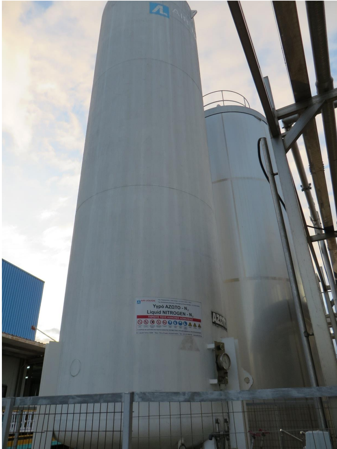
Φωτογραφία 3.2.3.6 Δεξαμενή Αζώτου
