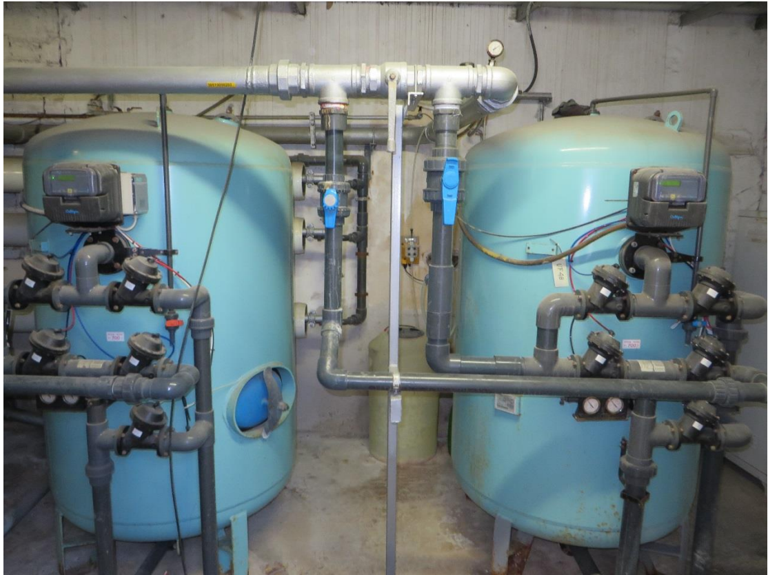
Φωτογραφία 3.2.3.2 Χώρος κατεργασίας νερού γεωτρήσεως – Διαδικασία αντίστροφης ώσμωσης
