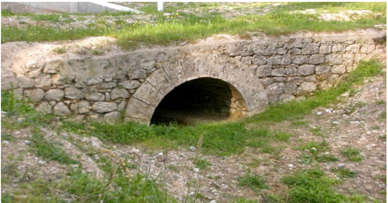
Εικόνα 51: Περίτεχνο πέτρινο γεφύρι στην είσοδο του χωριού κατασκευασμένο με πελεκημένα καμαρολίθια χρησιμοποιούνταν ως υδραγωγείο για την άρδευση των κτημάτων.
