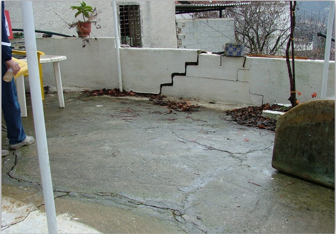
Εικόνα 65: Συνέπειες της κατολίστησης στις κατασκευές.
