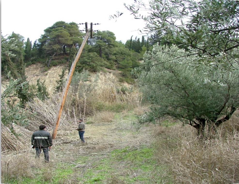
Εικόνα 67: Συνέπειες του φαινομένου της κατολίθησης στα κατάντη του χωριού.
