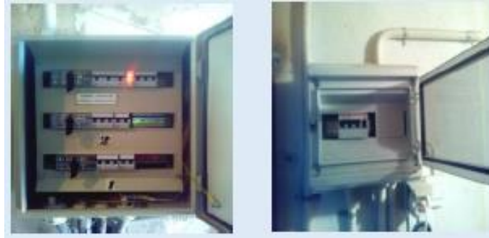
Εικόνα 6.17: Ηλεκτρικός πίνακας υδραυλικού ανελκυστήρα
