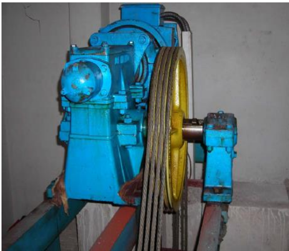
Εικόνα 6.13: Άποψη κινητήρα ηλεκτρομηχανικού ανελκυστήρα
