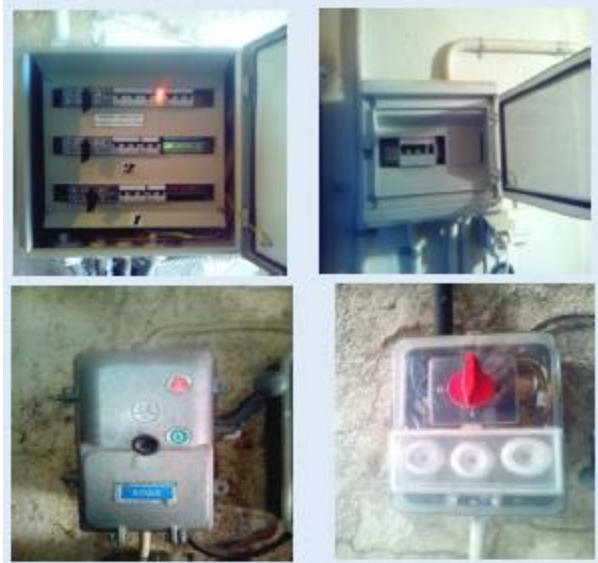
Εικόνα 6.14: Γενικοί διακόπτες ηλεκτρομηχανικού ανελκυστήρα
