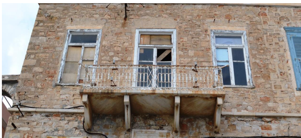
Εικόνα 43. Σπασμένα παράθυρα στον Β' όροφο του κτηρίου. (πηγή: προσωπικό αρχείο)
