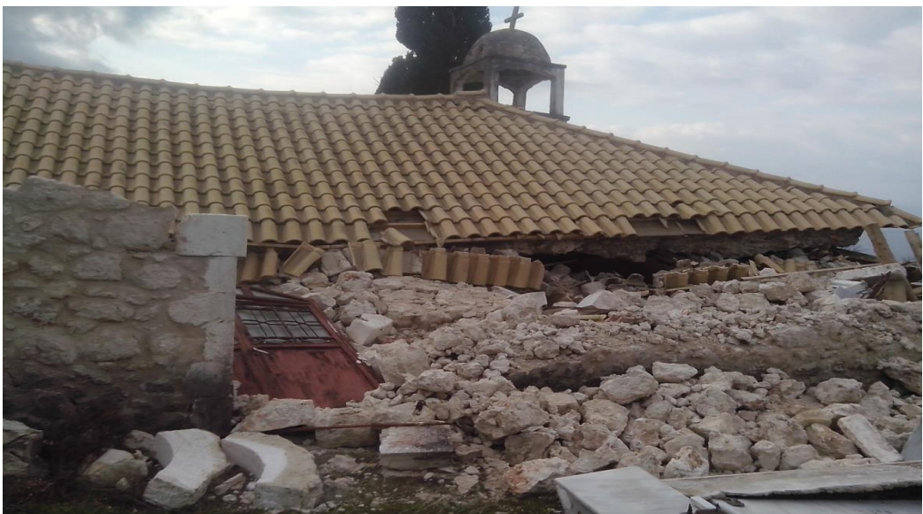
Φοτ. 172 έως 174: Η όψη της Μονής μετά τον σεισμό
