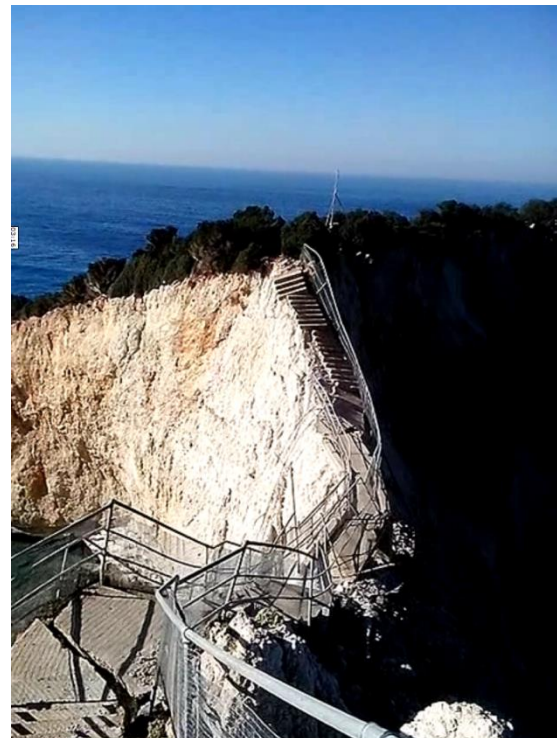
Φωτ. 8: Η γέφυρα μετά τον σεισμό
