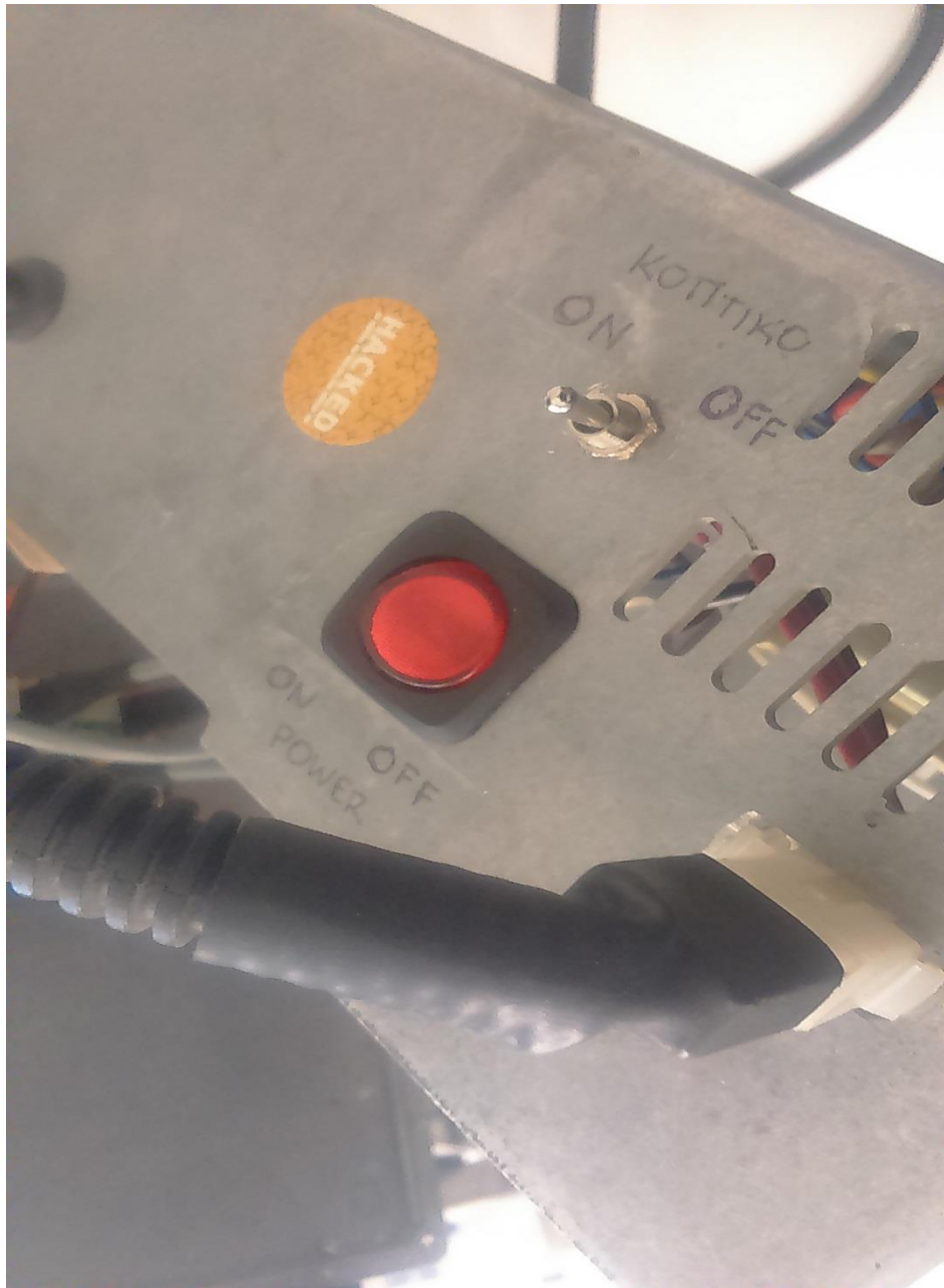
Εικόνα 2.26: Οι δύο διακόπτες
