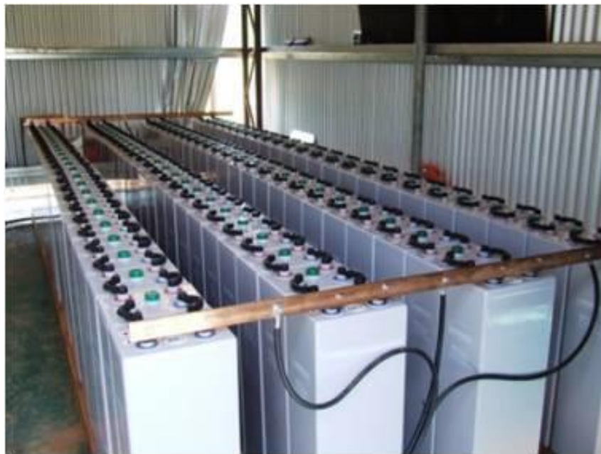
Εικόνα 26: Συστοιχίες συσσωρευτών για αποθήκευση ηλεκτρικής ενέργειας σε φωτοβολταϊκό πάρκο
