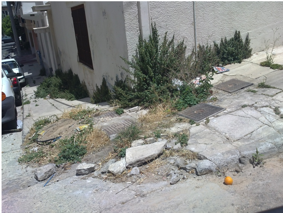
Εικόνα 106: Η εικόνα μιλάει από μόνη της. Επίσης στην οδό Μάρκου Μπότσαρη, 5 μέτρα μόλις μακριά από την από πάνω εικόνα, βλέπουμε ένα διαλυμένο πεζοδρόμιο. Φαίνεται ότι υπάρχουν πολλά ρολόγια της ΕΥΔΑΠ οπότε με το να ανοίγουν και να κλείνουν τρύπες δημιουργήθηκε αυτό που βλέπουμε.
