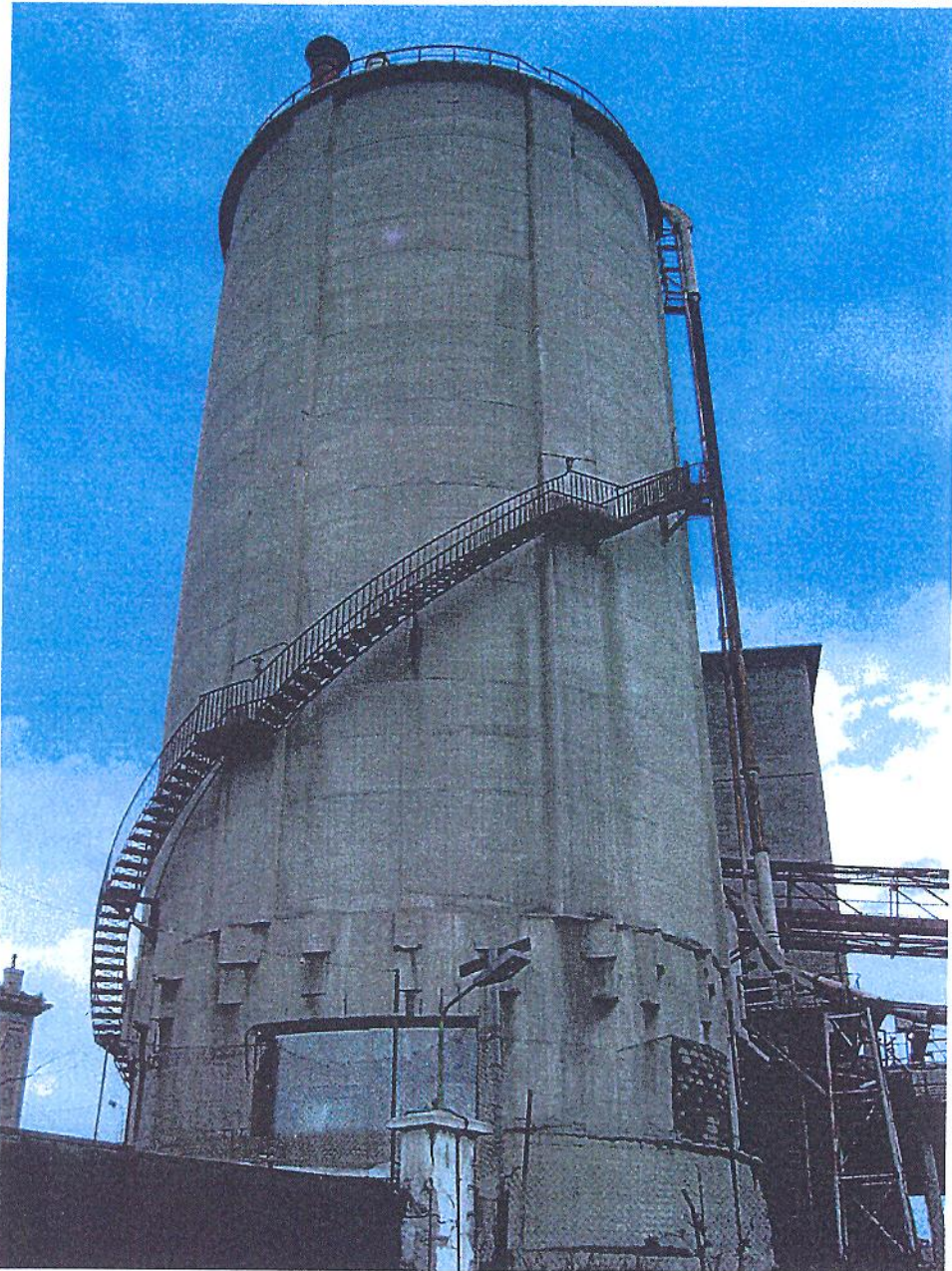
Φωτο. 10: ΕΓΚΑΤΑΣΤΑΣΕΙΣ ΑΓΕΤ – ΗΡΑΚΛΗΣ ΠΑΡΑΠΛΕΥΡΩΣ ΤΗΣ ΒΡ
