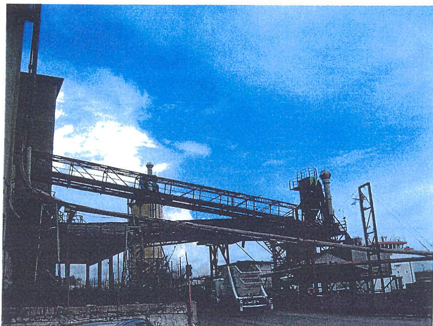
Φωτο. 8: ΕΓΚΑΤΑΣΤΑΣΕΙΣ ΑΓΕΤ – ΗΡΑΚΛΗΣ ΠΑΡΑΠΛΕΥΡΩΣ ΤΗΣ ΒΡ
