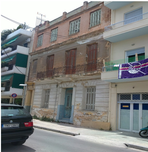
Εικόνα 41: Τριώροφο εγκαταλελειμμένο προσφυγικό κτίριο στην Οδό Μονεμβασιάς 25.
