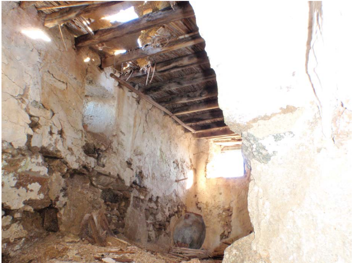
Εικόνα 6-4. Κατεστραμμένη στέγη και τοιχοποιία
