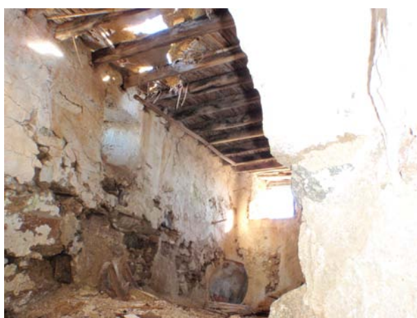
Εικόνα 6-15. Κατεστραμμένοι σοβάς και οροφή στο εσωτερικό του σπιτιού.
