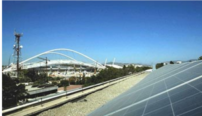
Εικ 4.10 Εφαρμογή Φ/Β στη στέγη της Γερμανικής Σχολής στο Μαρούσι
