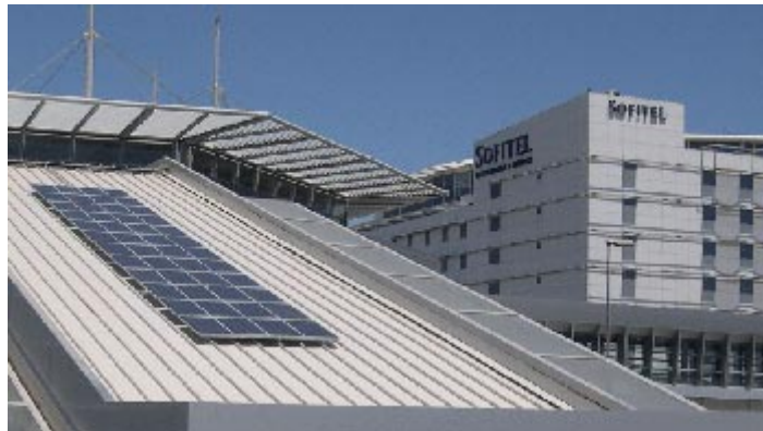
Εικ 4.8 Ενσωμάτωση Φ/Β στο σταθμό του μετρό στο αεροδρόμιο Ελευθέριος Βενιζέλος
