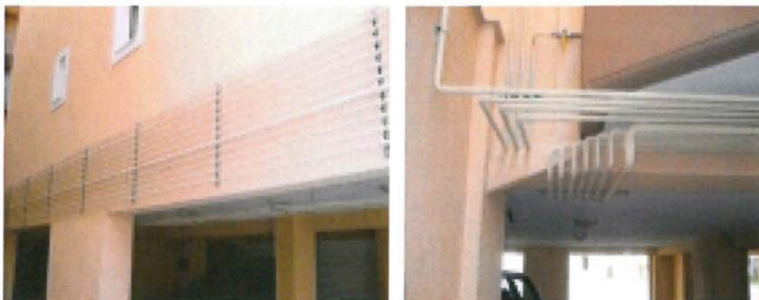
Εικόνα 6 Σωλήνωση φυσικού αερίου με ράγα στήριξης, υπόγεια γραμμή φυσικού αερίου,
