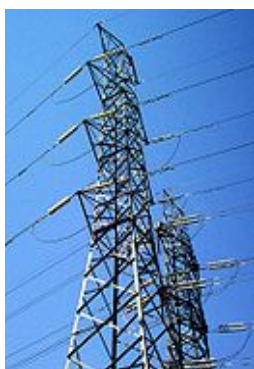
Σχήμα 17.1 Ηλεκτρικό δίκτυο: πηλώνες και καλώδια διανομής ηλεκτρικής ενέργειας
