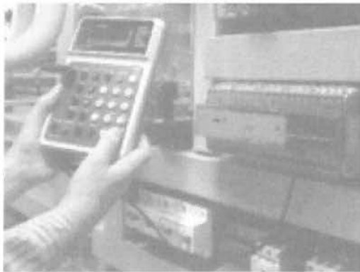
Σχ.5.9: Έλεγχος βλαβών σε εγκατάσταση αυτοματισμού με PLC.
