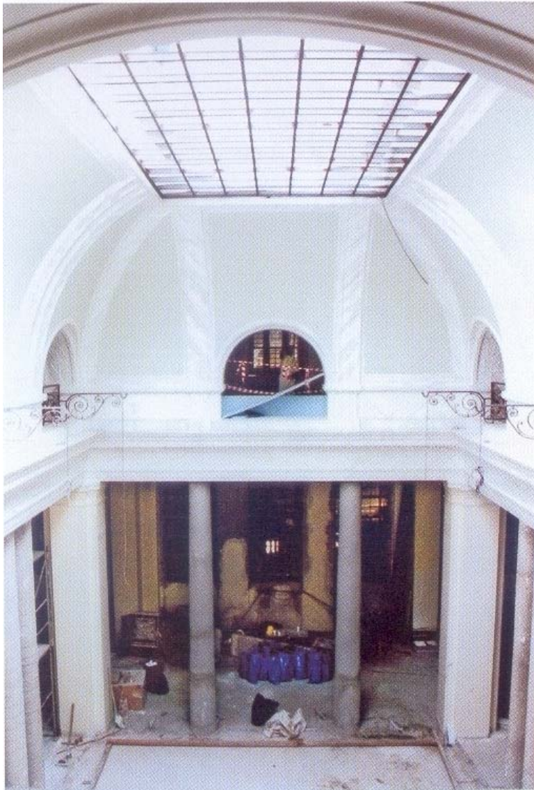
69. Α.Σ. Καλλιγιάς, αποκατάσταση κτιρίου Ιονικής Τράπεζας, Πεσμαζόγλου 12 (1999-2002). Άποψη της αίθουσας συναλλαγών (εργοτάξιο). [Πηγή: Αρχείο Διεύθυνσης περιουσίας Alpha Bank]
