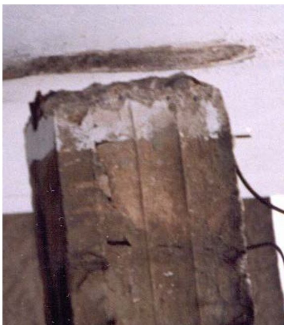
Φωτογραφία 3.3.Ανεπαρκείς αγκύρωση.
