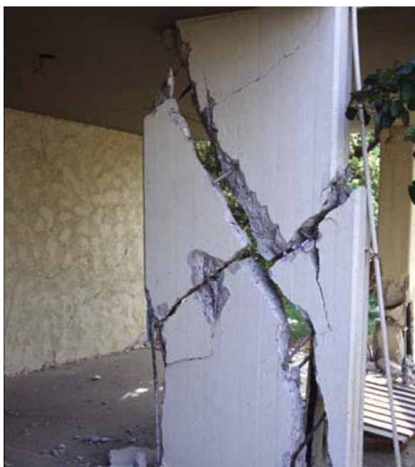
Φωτογραφία 3.4. Διατμητική αστοχία τοιχίου.
