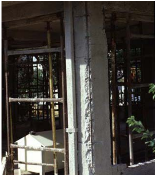
Φωτογραφία 3.1. Διάσπαση επικάλυψης σκυροδέματος.
