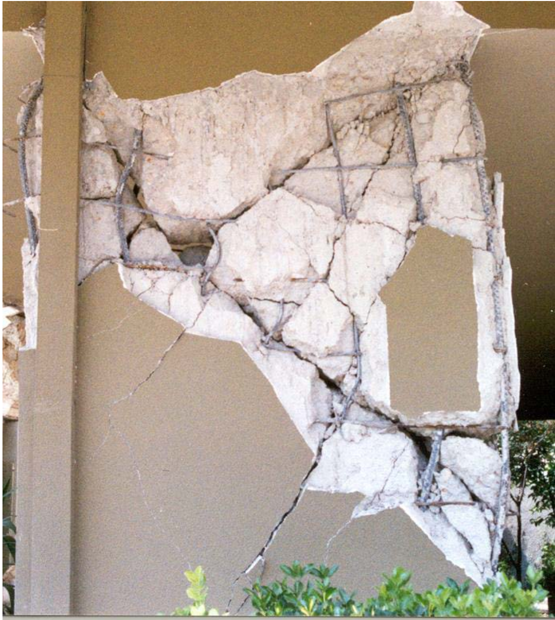
Φωτογραφία 3.5. Διατμητική αστοχία τοιχίου.
