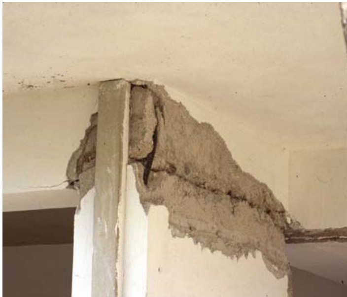
Φωτογραφία 3.2.Ανεπαρκείς αγκύρωση ράβδων τοιχίου-δοκαριού.
