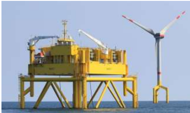
Εικόνα 6.5 11 Υπεράκτιος σταθμός μετατροπής AC/DC
