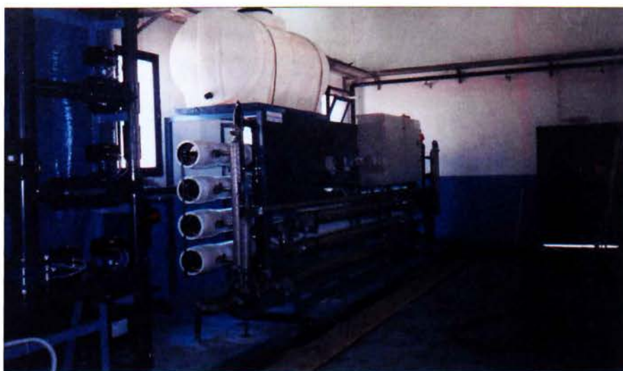
Σχήμα 2.15 Μονάδα αντίστροφης όσμωσης στη Νίσυρο δυναμικότητας 300 κβ/ημέρα. Πηγή : TEMAK
