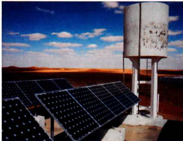
Σχήμα 3.2 Αυτόνομη μονάδα αντίστροφης όσμωσης με φωτοβολταϊκά στην Τυνησία Πηγή : ProDes project, ITC
