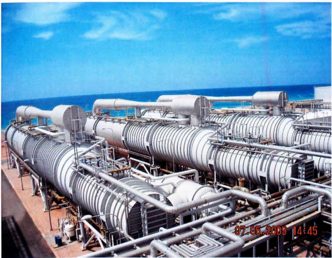
Σχήμα 2.6 Μονάδα αφαλάτωσης πολυβάθμιας εκτόνωσης (MED) στην Abutaraba της Λιβύης με δυναμικότητα 40.000 κβ/ημέρα Πηγή : Φωτογραφικό αρχείο SIDEM
