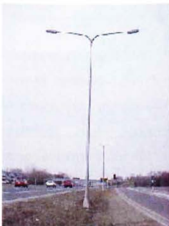
Σχήμα 3.8: Στόλος φωτισμού με διπλό βραχίονα
