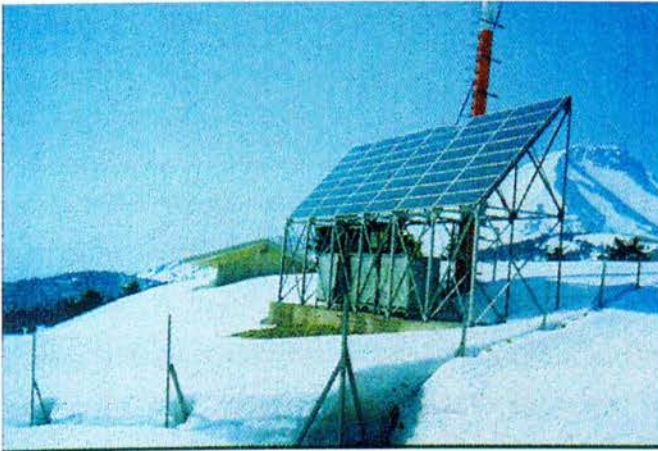
Σχήμα 1.8: Αυτόνομο φωτοβολταϊκό σύστημα τηλεπικοινωνιών στο όρος Δίρφη
