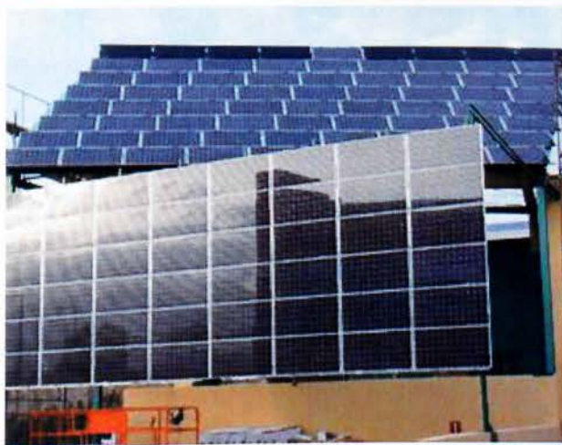
Σχήμα 1.13: Το φωτοβολταϊκό σύστημα του ΚΑΠΕ
