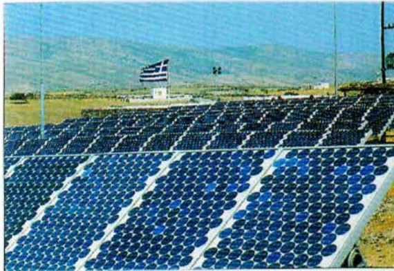
Σχήμα 1.11: Το φωτοβολταϊκό πάρκο της ΔΕΗ στην Κύθνο
