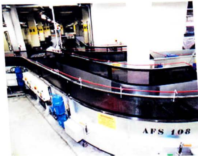
Σχήμα 4.5 Μεταφορική ταινία διαχείρισης αποσκευών σε αεροδρόμιο.
