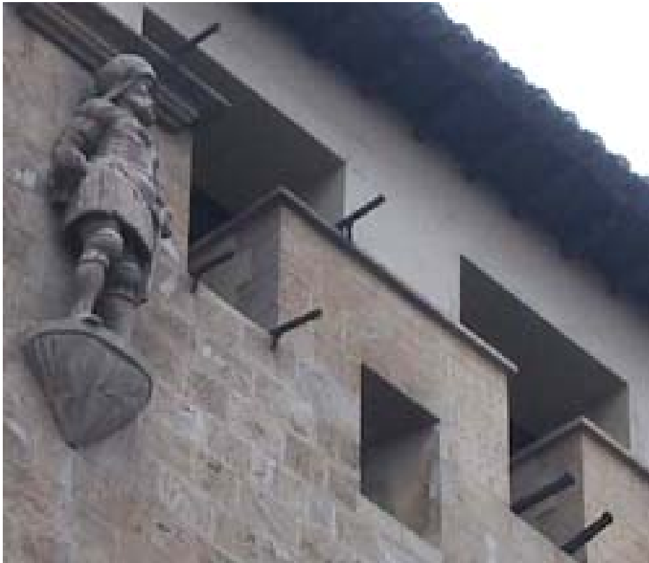
Εικόνα 28: Σε αυτήν τη φωτογραφία μπορούμε να ξεχωρίσουμε τις πολεμίστρες και τα αγάλματα του κτιρίου
