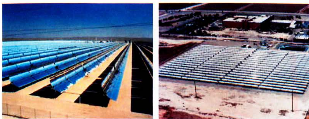
Σχήμα 3.49. Φωτογραφίες από σταθμό ηλεκτροπαραγωγής παραβολικών κοίλων [Αριστερά: Kramer Junction - Δεξιά: Gould Electronics]
