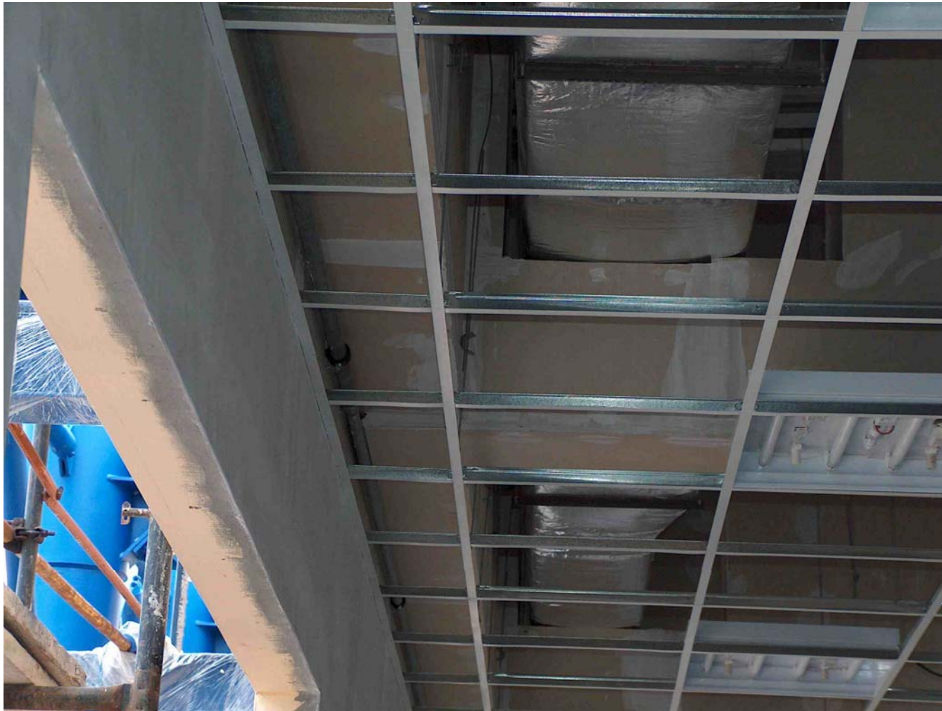
ΠΥΡΟΠΡΟΣΤΑΣΙΑ ΜΕ ΧΡΗΣΗ ΠΥΡΑΝΤΟΧΩΝ ΣΑΝΙΔΩΝ ΣΤΗΝ ΝΕΑ ΒΙΒΛΙΟΘΗΚΗ ΤΟΥ ΤΕΙ ΠΕΙΡΑΙΑ
