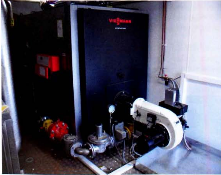
Εικόνα 1.4.3-1: Καυστήρας βιοαερίου για την παραγωγή θερμότητας (AGRINZ GmbH, 2008)
