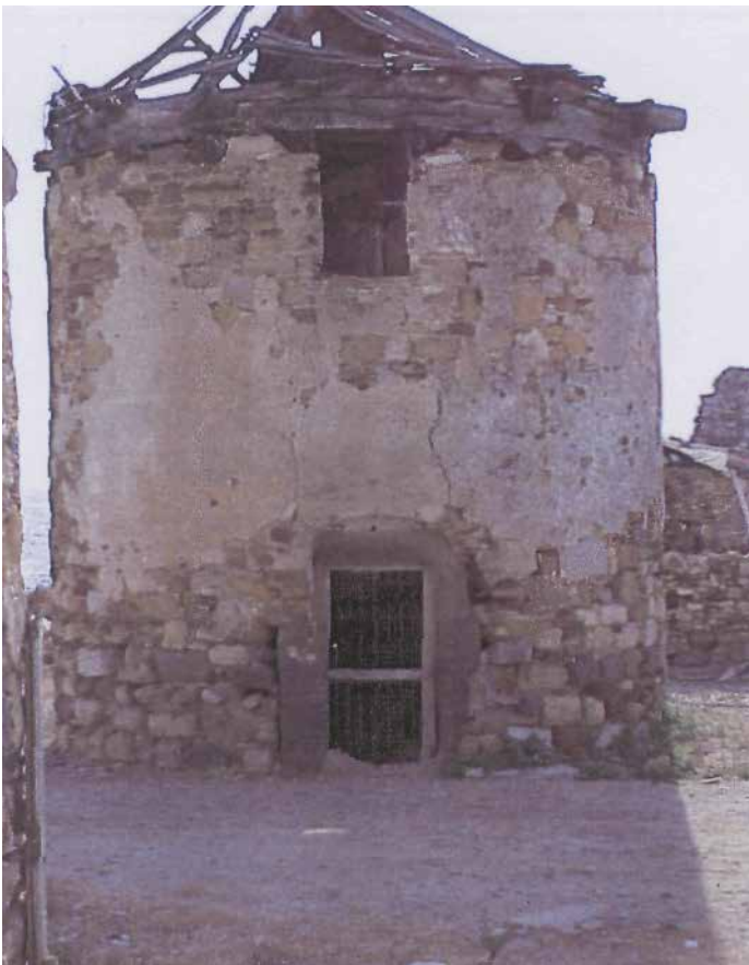
Γενικές περιμετρικές απόψεις του μύλου (2).φαίνονται οι ρωγμες ,τα επιχρίσματα και το αρμολόγημα της τοιχοποιίας όπως είναι σημερα. επίσης ο βαθμός καταστροφής της στέγης.
