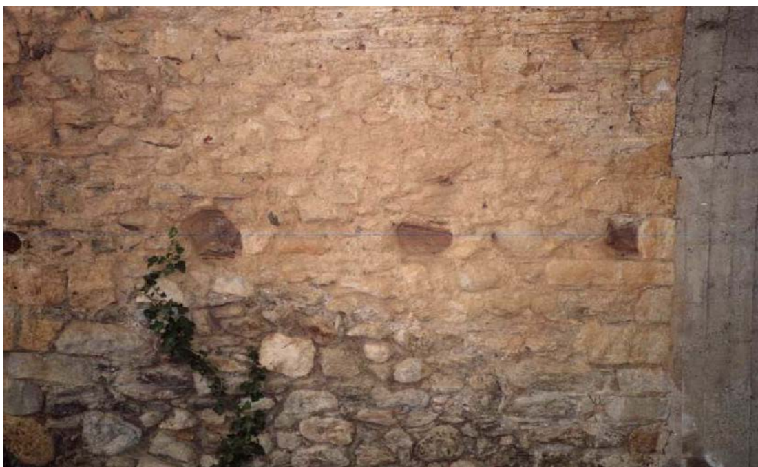
Γεφύρι Μυστρά. Εσωτερική – αριστερή πλευρά καμάρας. Οι τρεις τρύπες αυτές είναι από τα ξύλινα μαδέρια που τοποθετούσαν οι μαστόροι για να στηρίζονται πάνω σε αυτά και να χτίζουν το γεφύρι.
