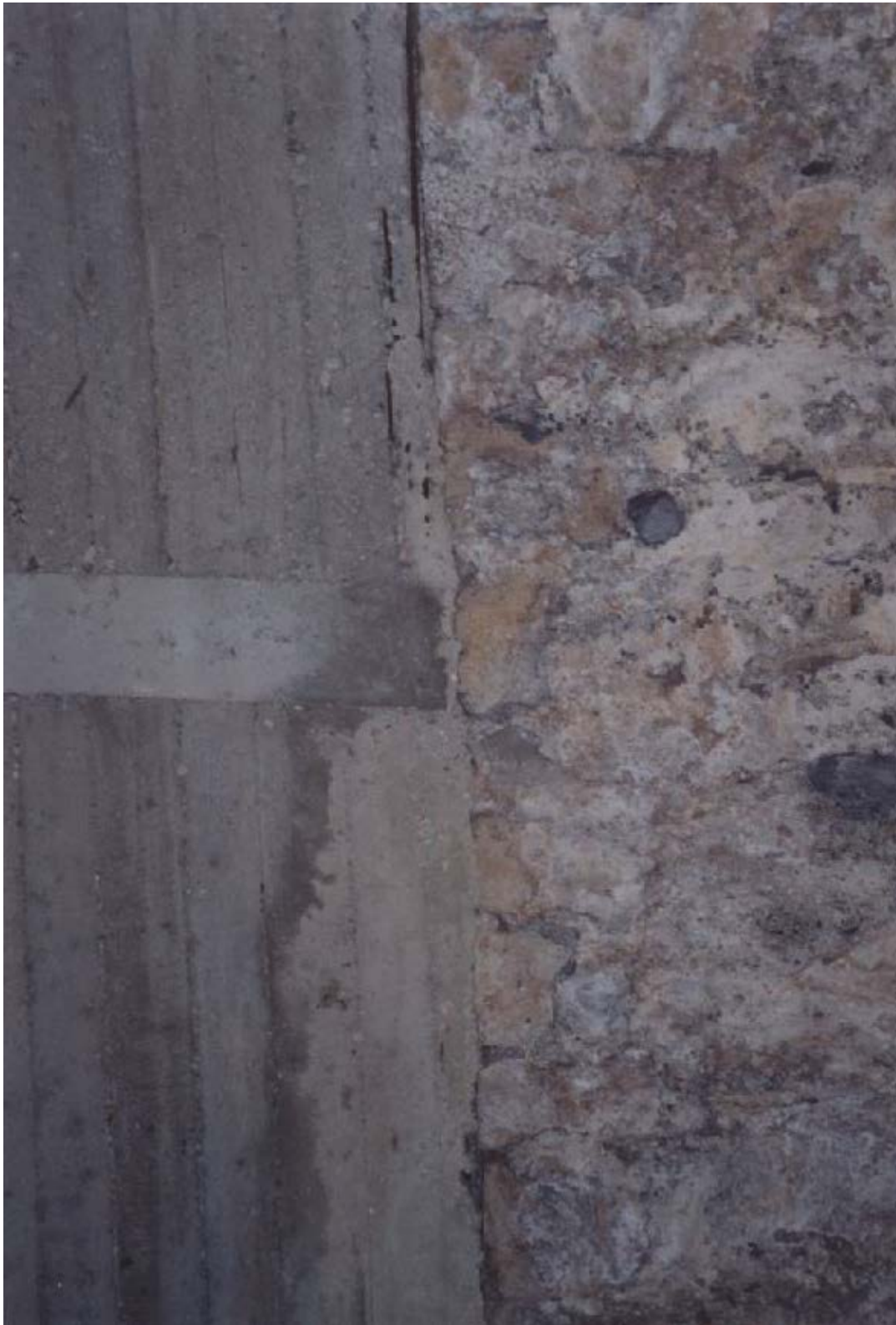
Γεφύρι Μυστρά. Εσωτερική και πάνω μεριά καμάρας. Εδώ βλέπουμε την ένωση πέτρας – Μπετόν Αρμέ , και είναι εμφανής ο εσωτερικός οπλισμός του σκυροδέματος.
