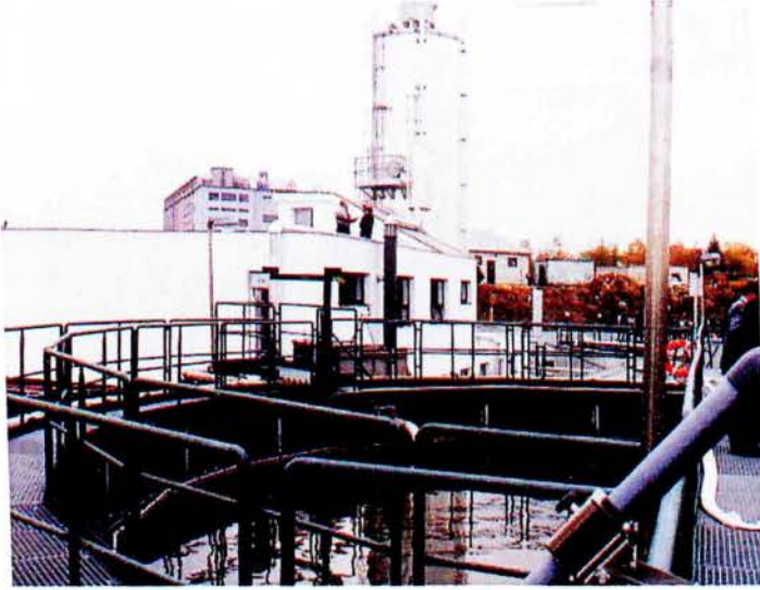
ΕΙΚΟΝΑ 5.26: Σταθμός συλλογής και επεξεργασίας υγρών αποβλήτων
