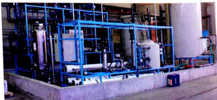
ΕΙΚΟΝΑ 5.21: Βιομηχανική εγκατάσταση επεξεργασίας υγρών αποβλήτων
