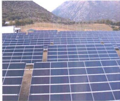
Εγκατάσταση φωτοβολταϊκού επί εδάφους
