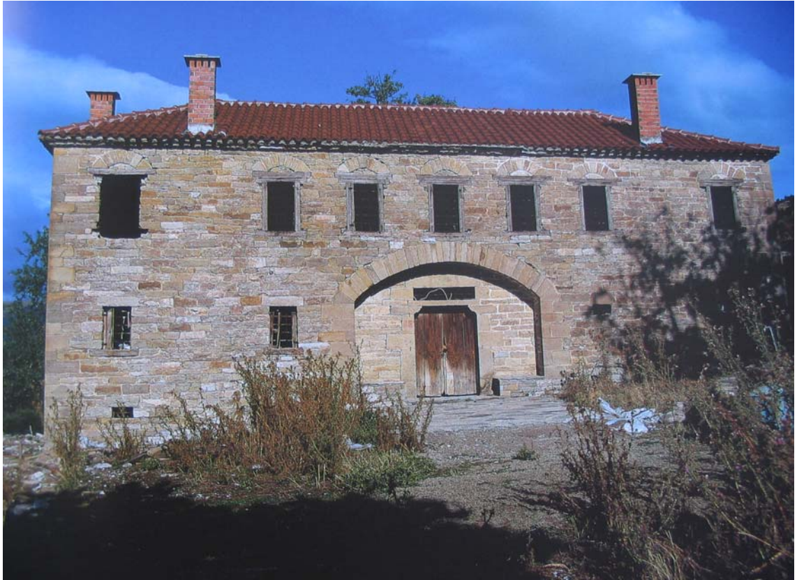
57. Λιθόκτιστη κατοικία κτισμένη από ντόπιους μαστόρους, στο χωριό Φιλιππαιοί. Μάλλον ανήκε σε κάποιο εύπορο της εποχής εκείνης.
