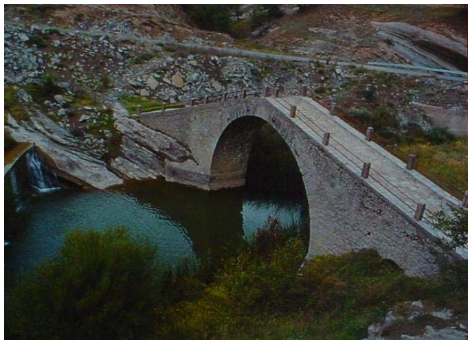
41. Η ανατολική όψη του γεφυριού της Μαέρης που βρίσκεται ανάμεσα στα χωριά Δασύλλιο και Τρίκορφο του Βοΐου (όπως έχει αναφερθεί σήμερα ανήκουν στο νομό Γρεβενών), πάνω στο Μαγεριώτικο ποτάμι.
