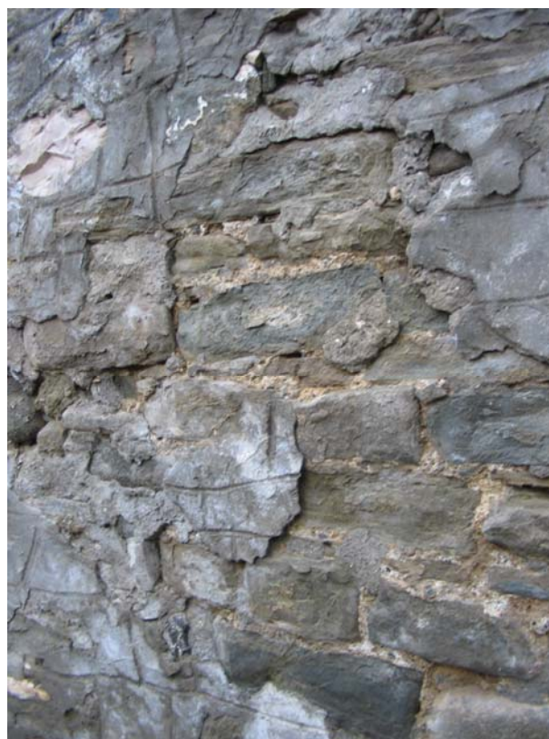
79.Εμφανής αποσάθρωση νέου και παλαιού κονιάματος.
