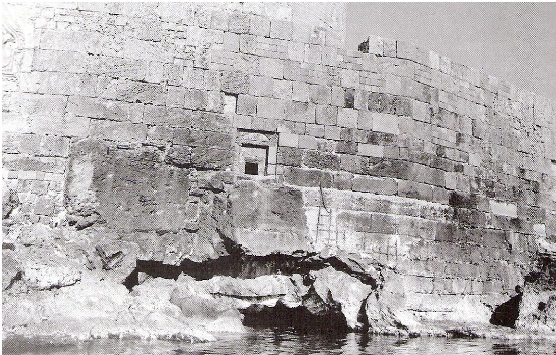
Εικόνα 6.18 Οι υποσκαφές των κυμάτων στη θεμελίωση του φρουρίου του Αγ. Νικολάου πριν την κατασκευή του λιμενικού έργου υποθεμελίωσης του
