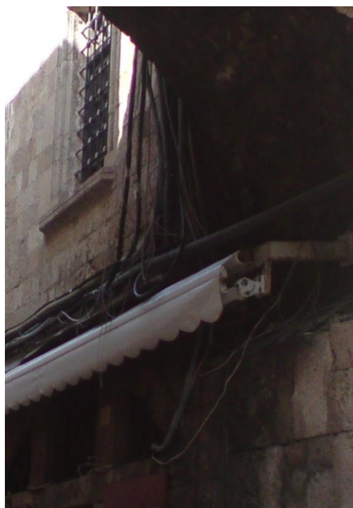
Εικόνα 7.6 Απαράδεκτη εικόνα με τα καλώδια να είναι στην πρόσοψη του κτηρίου
