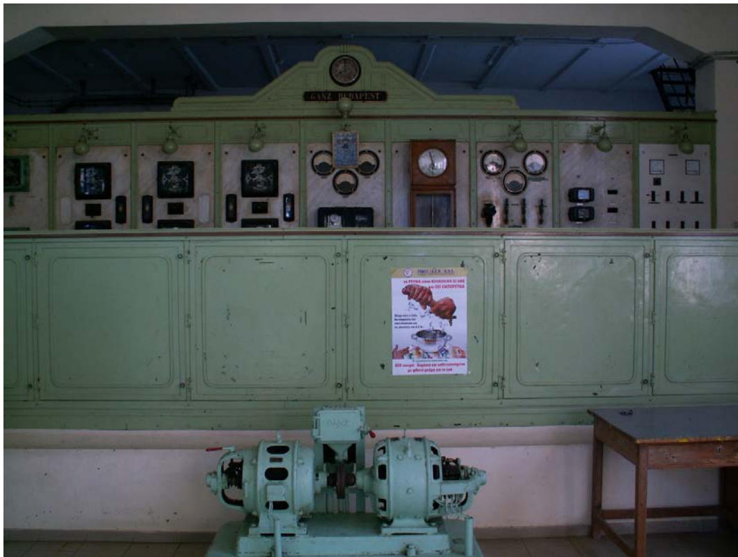
Εικόνα 33: Εσωτερικά του σταθμού
