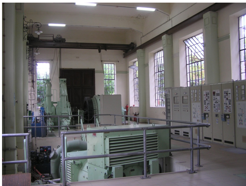
Εικόνα 16 - Εσωτερική άποψη σταθμού. Στα δεξιά της φωτογραφίας ο πίνακας ελέγχου και στο βάθος ο στρόβιλος Pelton.
