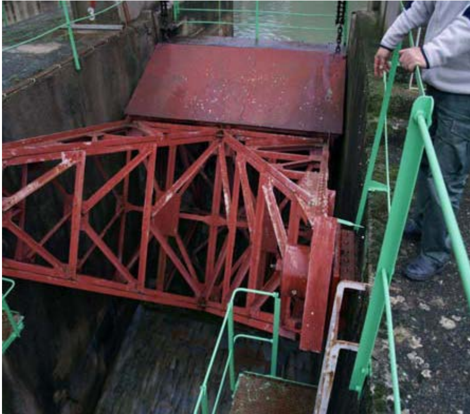
Εικόνα 12 - Ηλεκτρικό τοξωτό θυρόφραγμα (πηγή: ΔΕΗ Ανανεώσιμες Α.Ε.)
