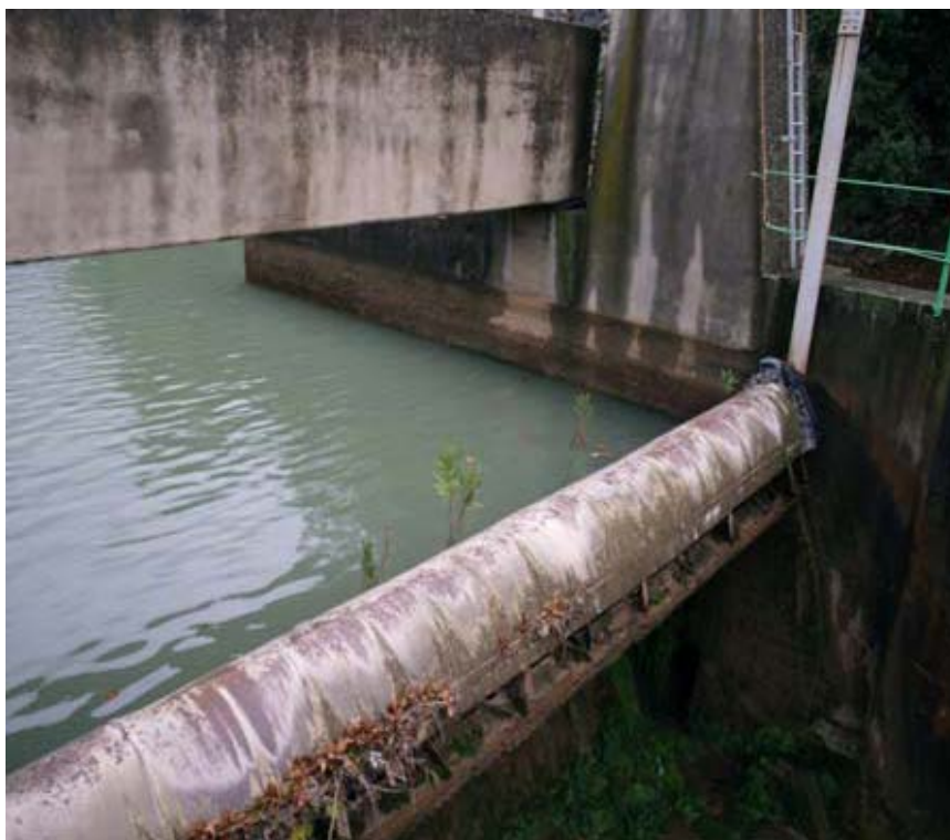
Εικόνα 14 - Αυτόματο θυρόφραγμα με αντίβαρο (πηγή: ΔΕΗ Ανανεώσιμες Α.Ε.)
