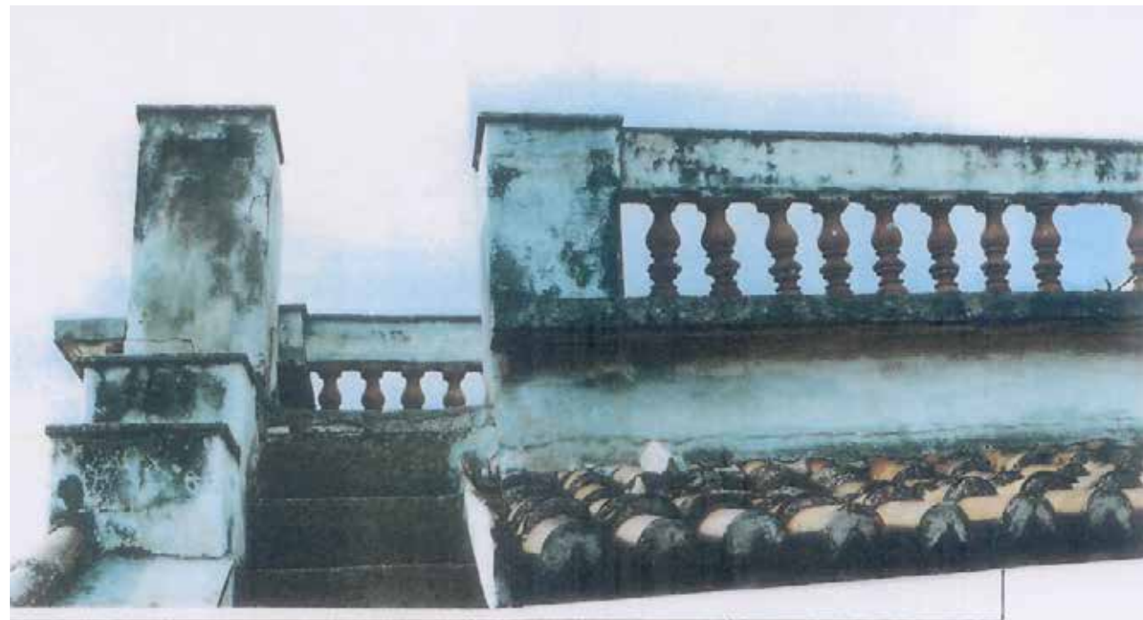
58, 59, 60, 61. ΦΘΟΡΕΣ ΑΝΩ ΔΟΜΑΤΟΣ
