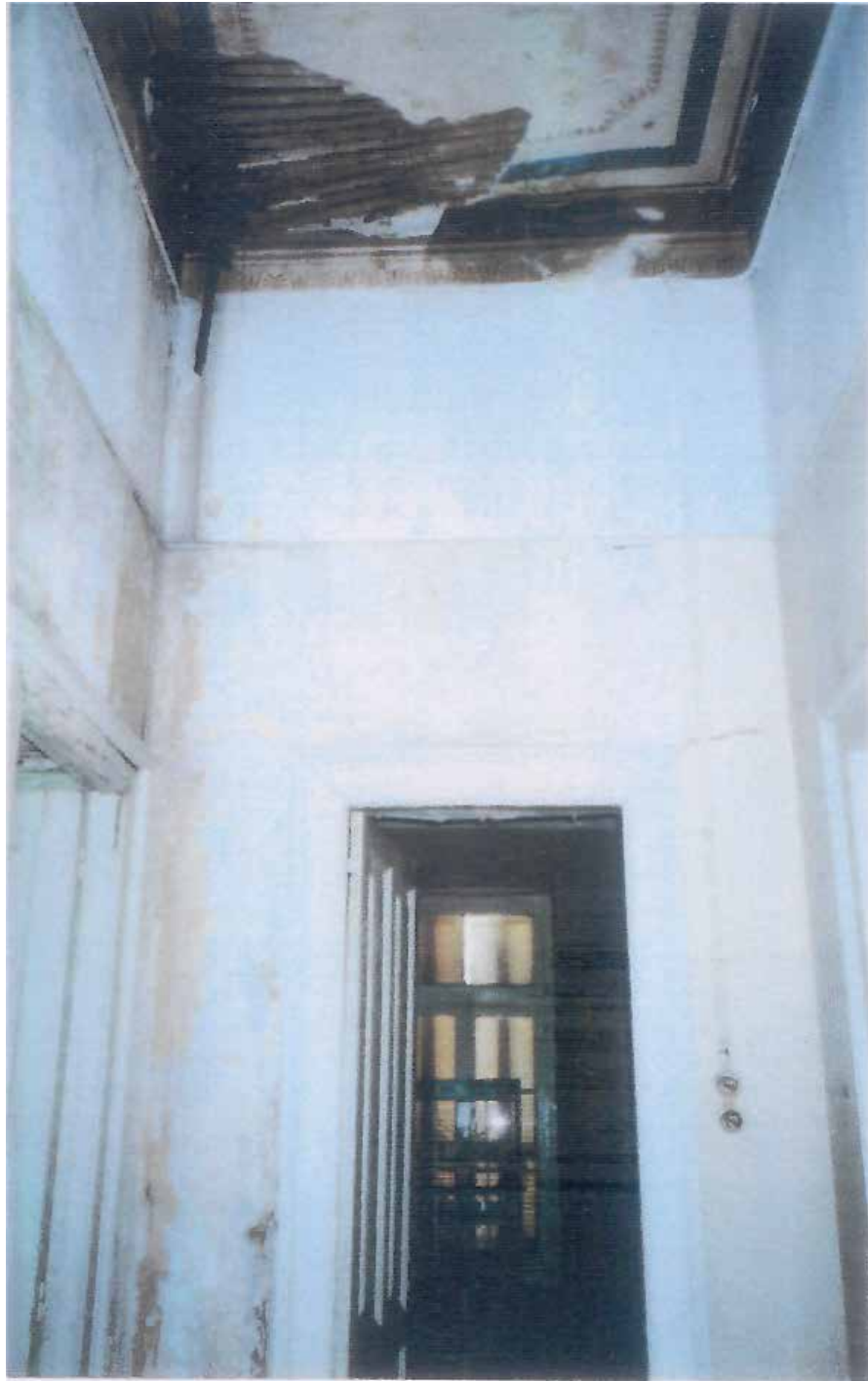
23. ΙΣΟΓΕΙΟ. ΧΩΡΟΣ Δ1 – ΦΘΟΡΕΣ ΟΡΟΦΟΓΡΑΦΕΙΑΣ ΚΑΙ ΤΟΙΧΩΝ ΑΠΟ ΕΙΣΡΟΗ ΝΕΡΟΥ ΒΡΟΧΗΣ
