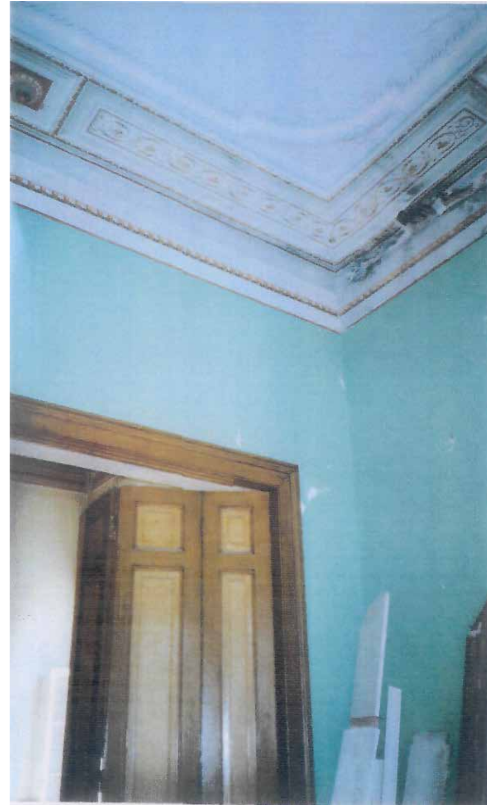
26. ΙΣΟΓΕΙΟ. ΧΩΡΟΣ Β1 – ΑΝΑΤΟΛΙΚΟΣ ΤΟΙΧΟΣ, ΔΕΞΙΟ ΤΜΗΜΑ – ΦΘΟΡΑ ΟΡΟΦΟΓΡΑΦΕΙΑΣ ΚΑΙ ΡΗΓΜΑΤΩΣΕΙΣ
