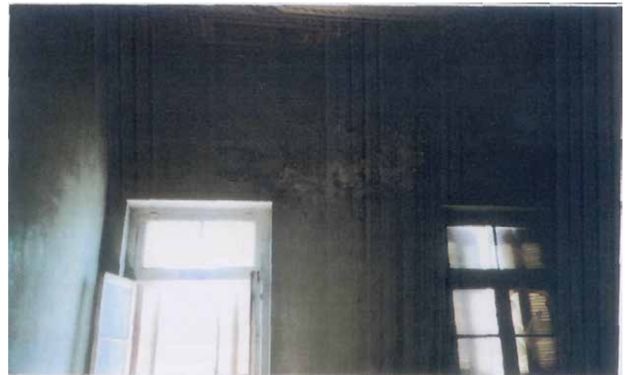
30. ΙΣΟΓΕΙΟ. ΧΩΡΟΣ Γ1 – ΔΙΑΚΡΙΝΕΤΑΙ Η ΥΓΡΑΣΙΑ ΚΑΙ Η ΜΕΡΙΚΗ ΚΑΤΑΣΤΡΟΦΗ ΟΡΟΦΟΓΡΑΦΙΑΣ ΑΠΟ ΤΗΝ ΕΙΣΡΟΗ ΝΕΡΟΥ ΒΡΟΧΗΣ ΣΤΟ ΝΟΤΙΟ ΤΟΙΧΟ
