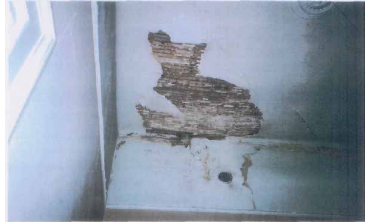
42.ΙΣΟΓΕΙΟ.ΧΩΡΟΣ Ζ1 – ΕΠΙΧΡΙΣΜΕΝΗ ΟΡΟΦΟΓΡΑΦΙΑ ΜΕ ΡΩΓΜΕΣ ΚΑΙ ΑΠΟΚΟΛΛΗΣΗ ΚΟΝΙΑΜΑΤΟΣ
