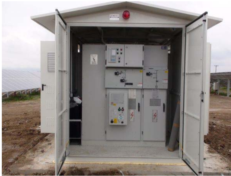
Εικόνα 14: Μετασηματιστής φωτοβολταϊκού σταθμού
