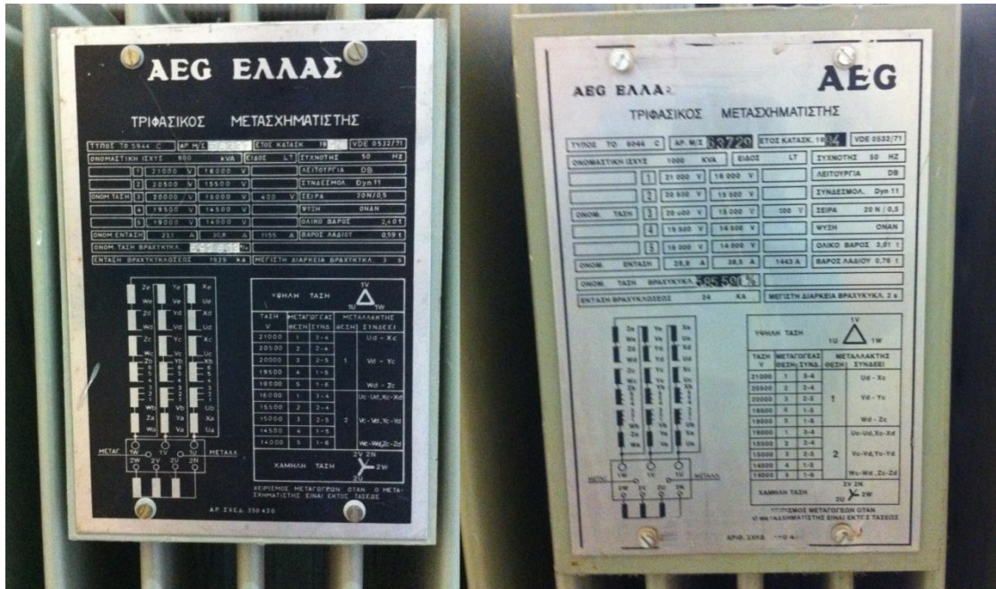
Εικόνα 3.26 Πινακίδες Μετασχηματιστών ελαίου ΜΤ
