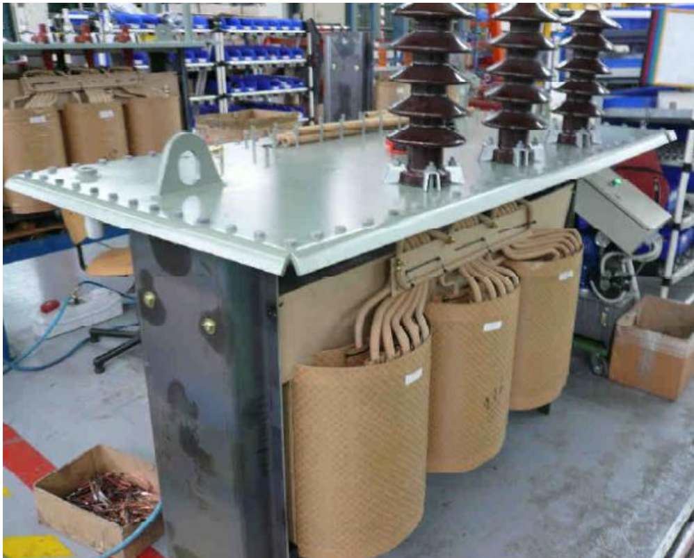
Εικόνα 3.27 Εσωτερική όψη των τυλιγμάτων ΜΣ μέσης τάσης.
