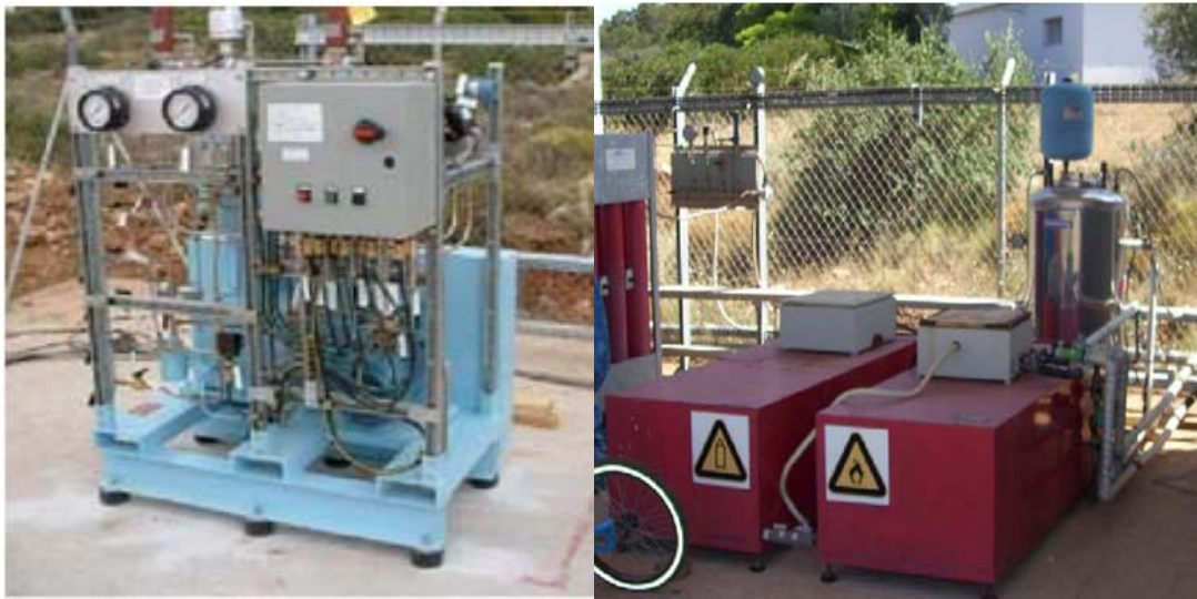
Σχήμα 44: Ο συμπιεστής υδρογόνου στο αιολικό πάρκο του ΚΑΠΕ και δεξαμενές μεταλλοϋδριδίων. (Πηγή: ΚΑΠΕ, Υλοποίηση και πρώτα αποτελέσματα από μονάδα παραγωγής υδρογόνου από αιολική ενέργεια)
