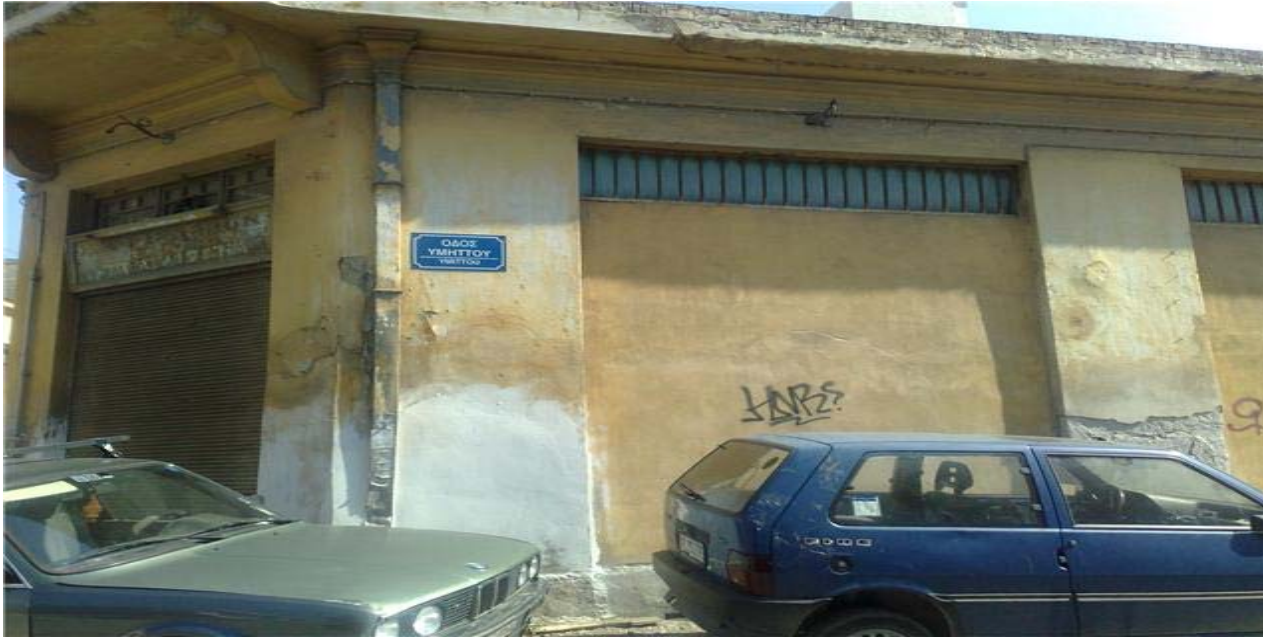
Α/Α 3. Οικοδ. Τετρ.218. «Εγκαταλειμμένο κτίριο. Παλιότερα λειτουργούσε ως καφενείο»
