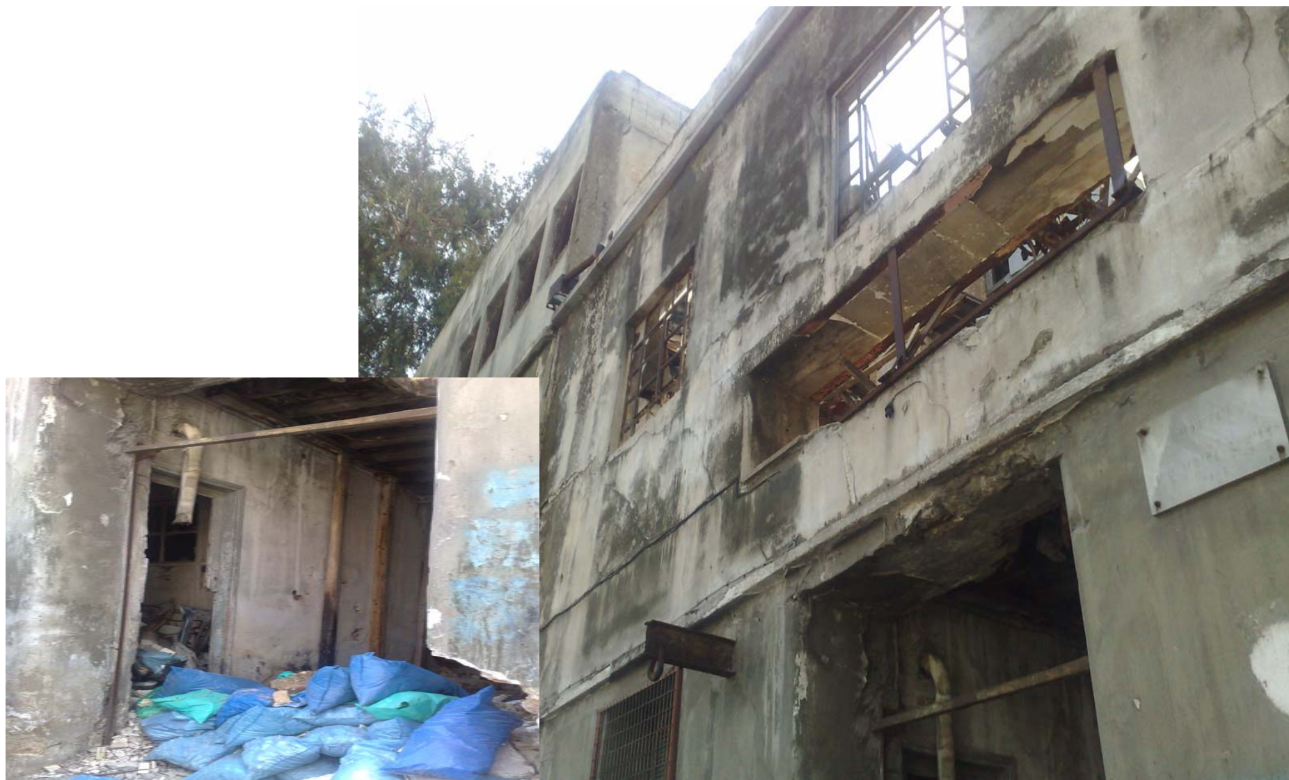
Α/Α 10. Οικοδ. Τετρ. 234. «Παρατημένο εργοστάσιο, Ιδιοκτησία Μοίρα & ΣΙΑ 1938. Επικίνδυνο προς κατεδάφιση»
