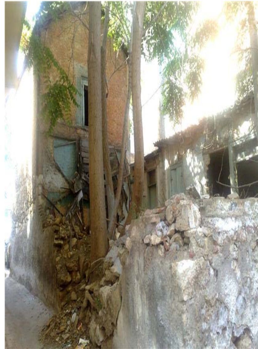
Α/Α 2. Οικοδ. Τετρ. 217. «Εγκαταλειμμένο σπίτι, υπό κατάρρευση»
