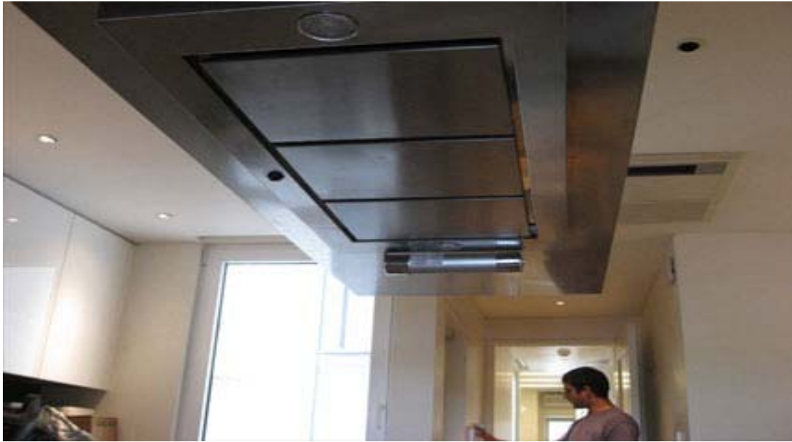
Σύστημα πυρόσβεσης BONPET σε χώρο της κουζίνας.
