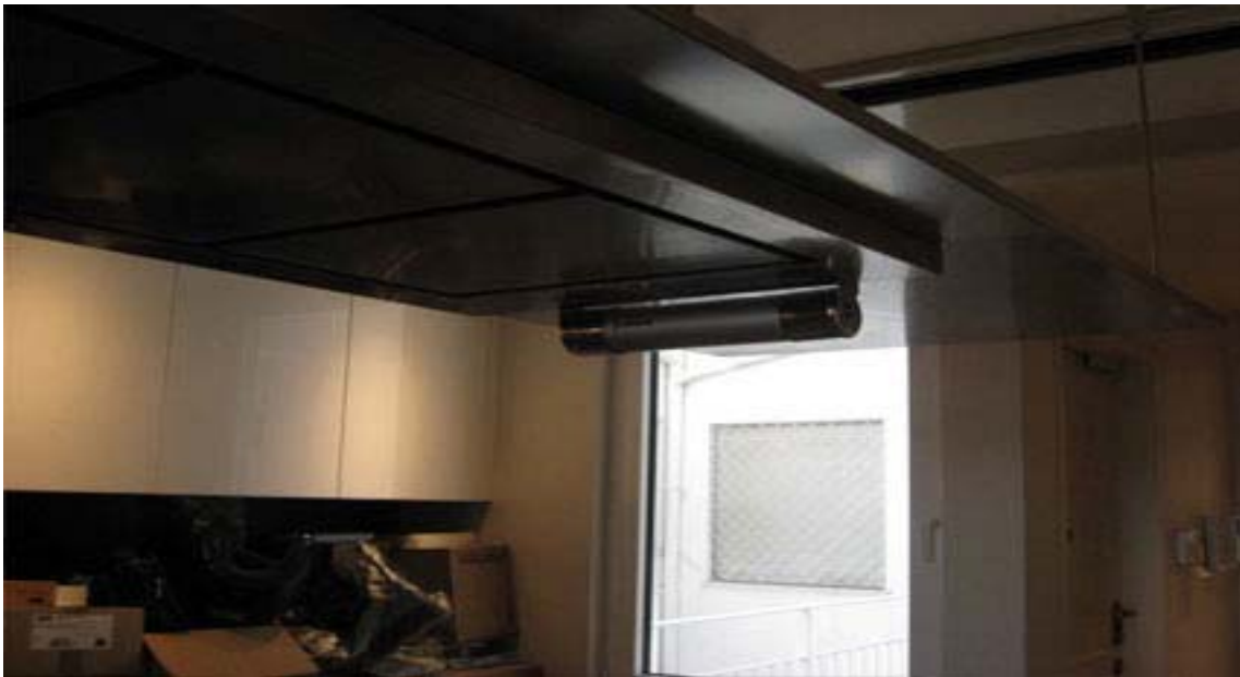
Σύστημα πυρόσβεσης BONPET σε χώρο της κουζίνας.
