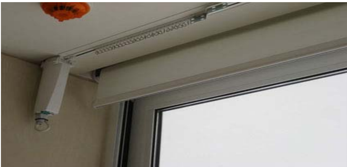
Σύστημα διαχείρισης ρολών σε κατοικία.
