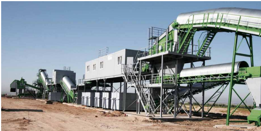
Εικόνα 73: Σταθερή μονάδα με εγκιβωτισμένους ταινιόδρους. (Πηγή: www.triaseco.gr )
