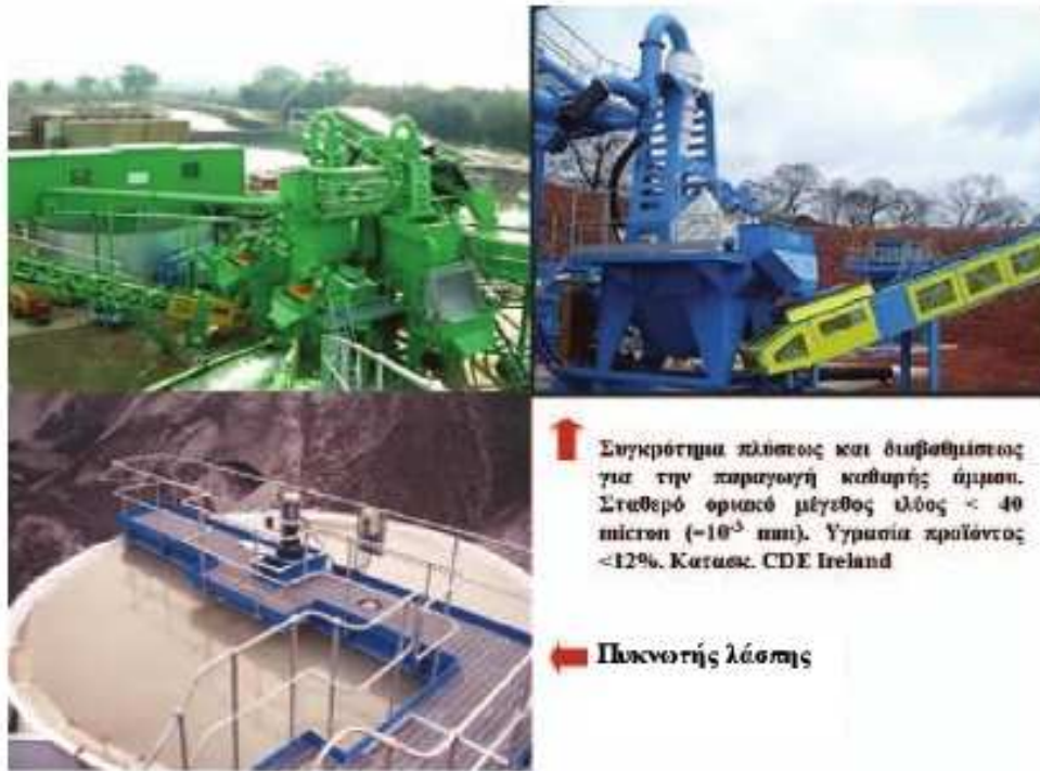
Εικόνα 35: Μηχανικές μονάδες του συγκροτήματος πλύσεως και διαβαθμίσεως αδρανών υλικών από ανακύκλωση παλαιών σκυροδεμάτων. (Πηγή: Χ. Ι. Εφραιμίδης, 2008)
