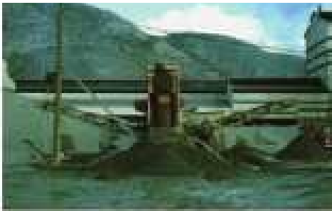
Συγκρότημα πλύσεως αδρανών υλικών τριών διαβαθμίσεων για το σκυρόδεμα των λεκανών ηλεκτρολύσεως εργοστασίου.
