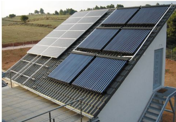
Εικόνα 67. Τα φωτοβολταϊκά της κατοικίας.
