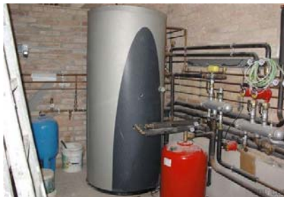
Εικόνα 13. Δεξαμενή αποθήκευσης (boiler)
