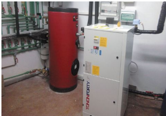
Εικόνα 77. Οι σωληνώσεις του γεωεναλλάκτη τροφοδοτούνται από μια “έξυπνη” αντλία θερμότητας.
