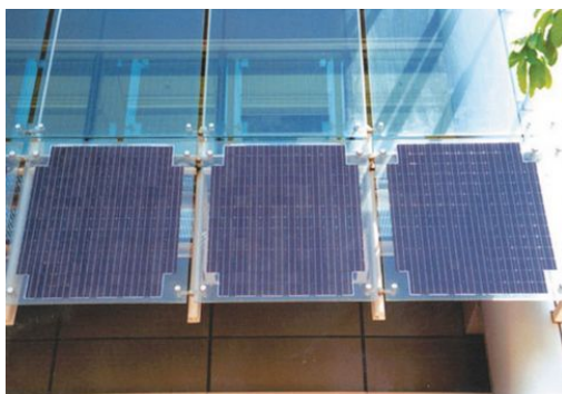
Εικόνα 17. Τα φωτοβολταϊκά στην πρόσοψη ενός κτιρίου αποτελούν την καλύτερη λύση από άποψη εξοικονόμησης χώρου, με μειωμένη όμως απόδοση λόγω της κάθετης τοποθέτησης.
