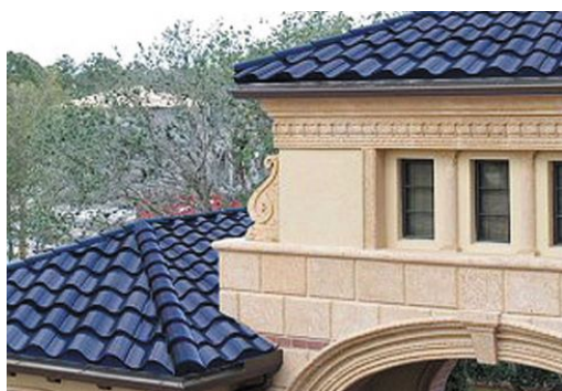
Εικόνα 36. Ενσωματωμένα φωτοβολταϊκά δεύτερης γενιάς, thin-film , με τη μορφή των παραδοσιακών κεραμιδιών φύλλων σε στέγη κτιρίου.
