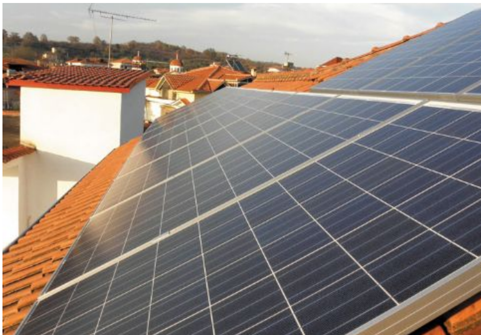
Εικόνα 8. Διάταξη φωτοβολταϊκών πλαισίων σε στέγη κατοικίας
