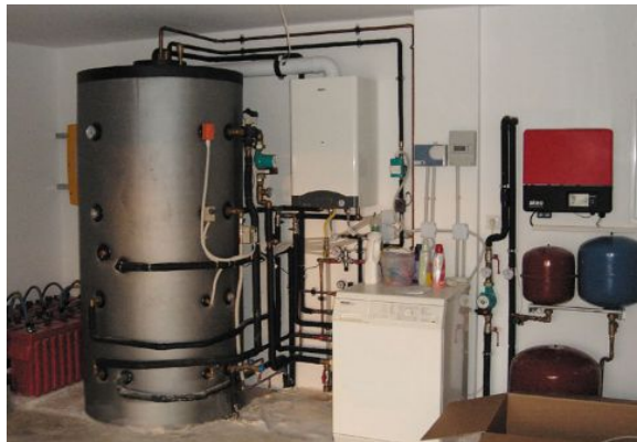
Εικόνα 70. Η συστοιχία των μπαταριών και το boiler στο λεβητοστάσιο της κατοικίας.
