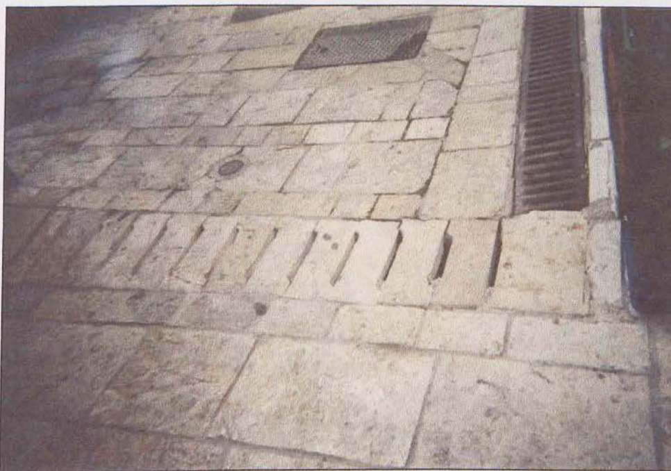
Εικόνα 104. Οι διάτρητες πλάκες, πέτρινες και μεταλλικές, μέσω των οποίων τα νερά οδηγούνται στους κεντρικούς αγωγούς αποχέτευσης.
