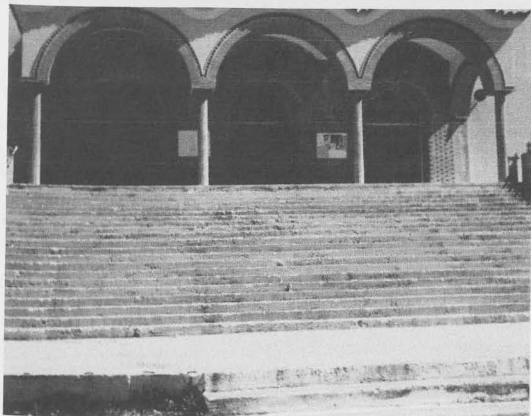
Εικ. 423 Εκκλησία Αγ. Τριάδας (Αλεξιουπόλεως – Αργυρούπολη), η οποία βρίσκεται στο τελευταίο στάδιο της κατασκευής της στην όψη της και στην επένδυση των σκαλοπατιών της.
