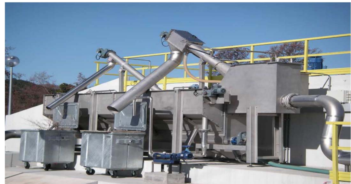
Εικόνα 3.2 Εγκατεστημένο συγκρότημα βιολογικής προεπεξεργασίας
