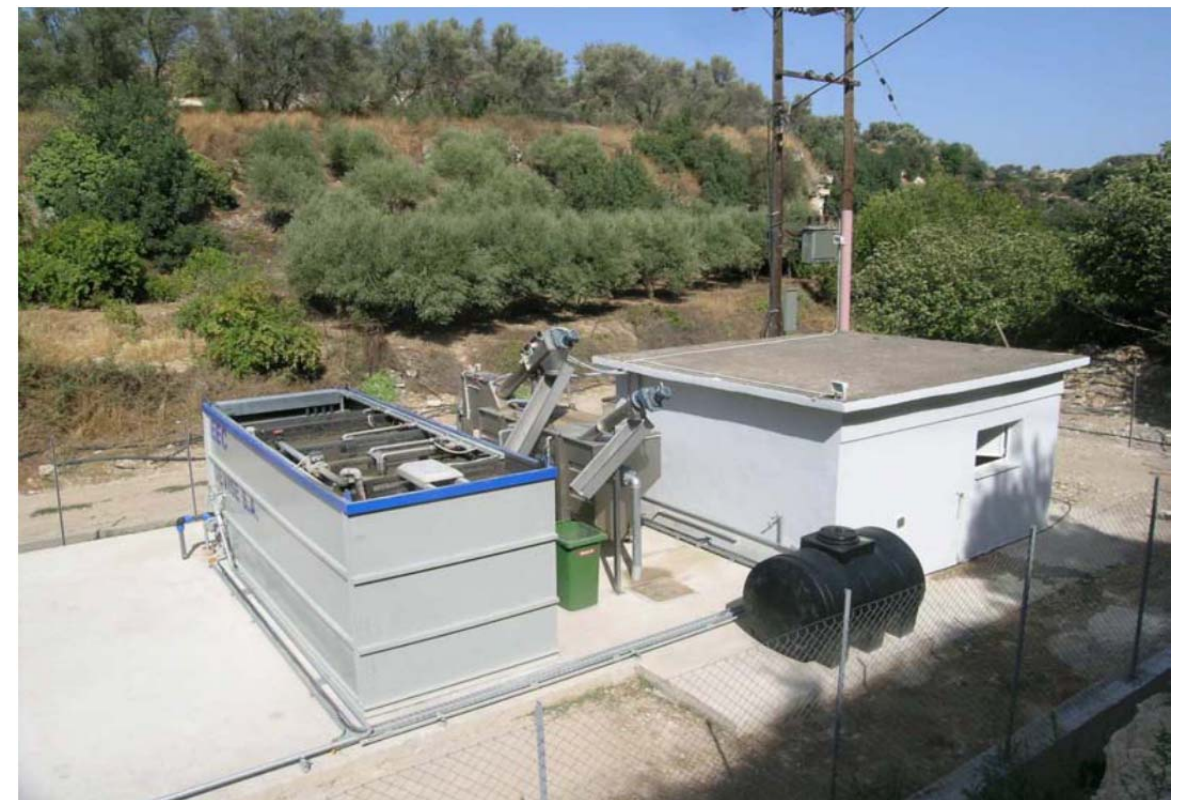
Εικόνα 3.5 : Εγκατεστημένη μονάδα εν λειτουργία, για εξυπηρέτηση 500 ι.κ. με πρόβλεψη για επέκταση έως και 1.300 ι.κ.
