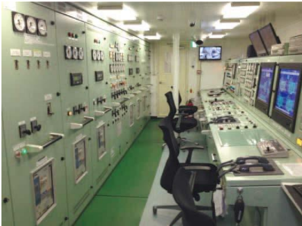
Εικόνα 5: Ένα τυπικό δωμάτιο ελέγχου της μηχανής (Engine Control Room, ECR), [36].
