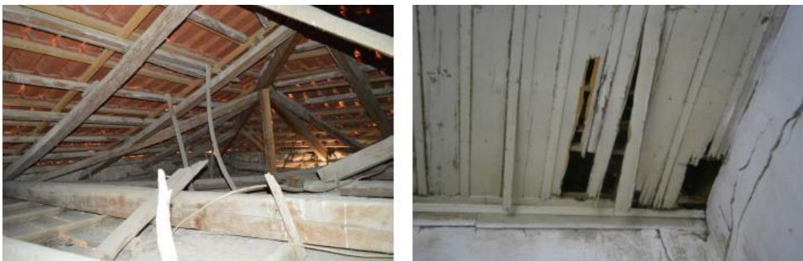
Εικόνα 1-25. Εσωτερικό στέγης & φθορές σε οροφή.
