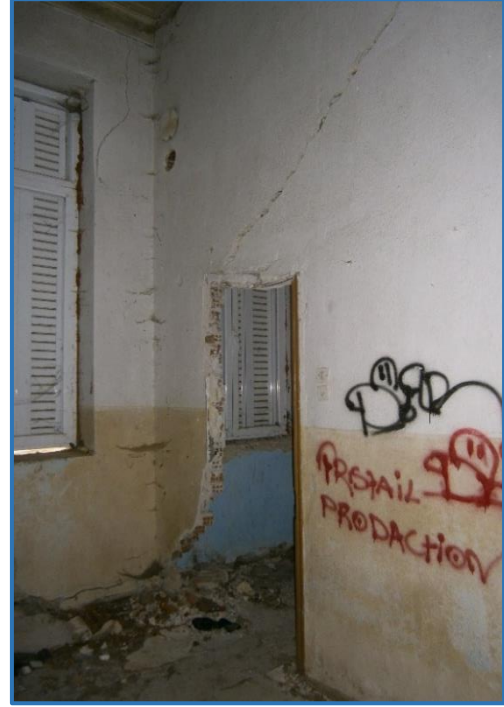
Εικόνα 1-37. Παθολογία εσωτερικού τοίχου (Γ-Δ).
