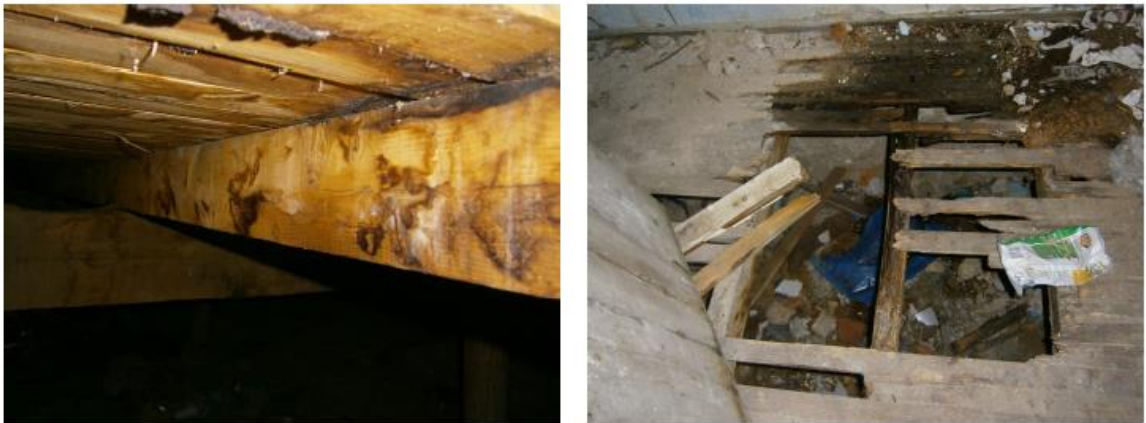
Εικόνα 1-24. Δοκοί στήριξης δαπέδου με έντονα σημάδια υγρασίας & οπή δαπέδου στο χώρο Β.
