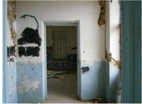
Εικόνα 1-20. Αποκόλληση εγκάρσιων τοίχων.
