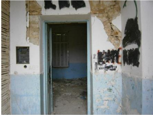
Εικόνα 1-19. Ρωγμές στα ανώφλια.
