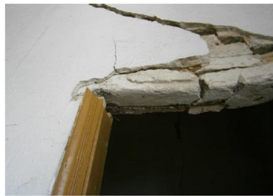
Εικόνα 1-22. Αποδιοργάνωση οπτοπλινθοδομής και αστοχία πρεκίου της θύρας.
