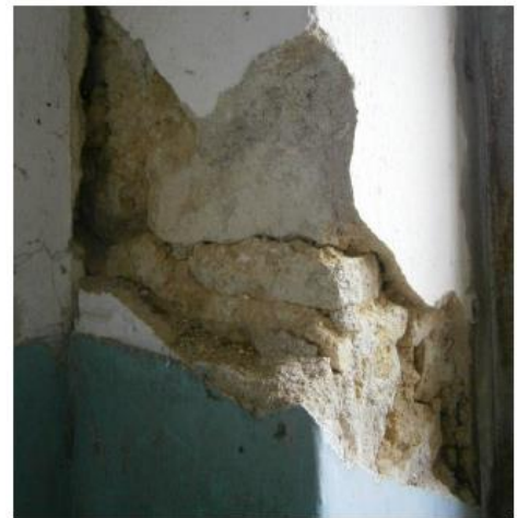
Εικόνα 1-18. Ρωγμή σε παραστάδες κεντρικής θύρας.
