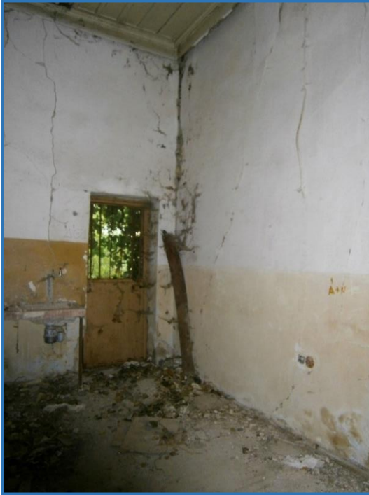
Εικόνα 1-36. Ρωγμές σε φέροντες τοίχους χώρου Δ.
