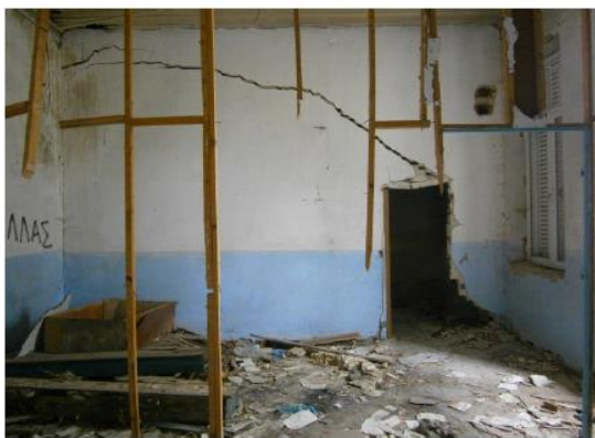
Εικόνα 1-21. Διαγώνια ρωγμή σε οπτοπλινθοδομή.
