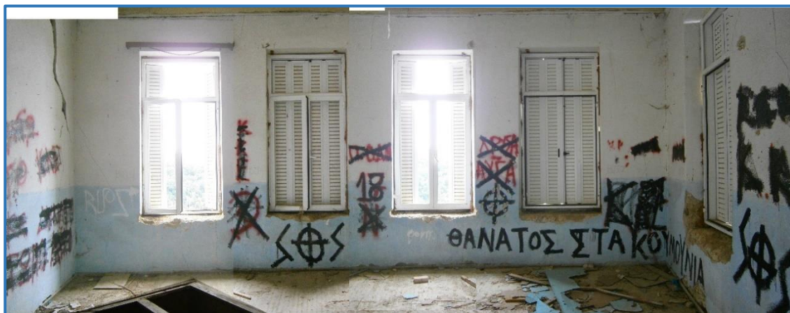
Εικόνα 1-32. Εμφανής παθολογία στην τοιχοποιία και στα ανοίγματα του χώρου Β.
