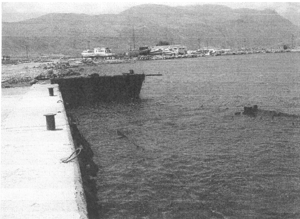
Φωτ. 3.23: Μικρό κρηπίδωμα στην νότια πλευρά της λιμενολεκάνης – Ναυάγιο μπροστά στον κρηπιδότοιχο
