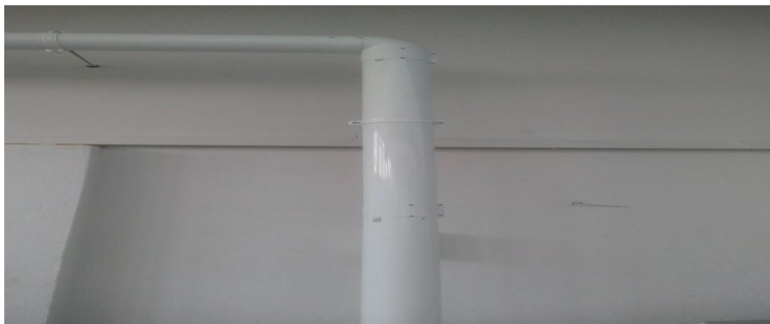
Εικόνα 18: Εγκατάσταση εργαστηρίου, σωλήνας εισαγωγής ατμοσφαιρικού αέρα και εξάτμισης καυσαερίων ομοαξονικού σωλήνα
