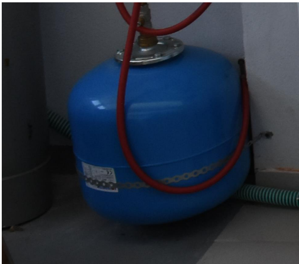
Εικόνα 17: Εγκατάσταση εργαστηρίου, δοχείο διαστολής
