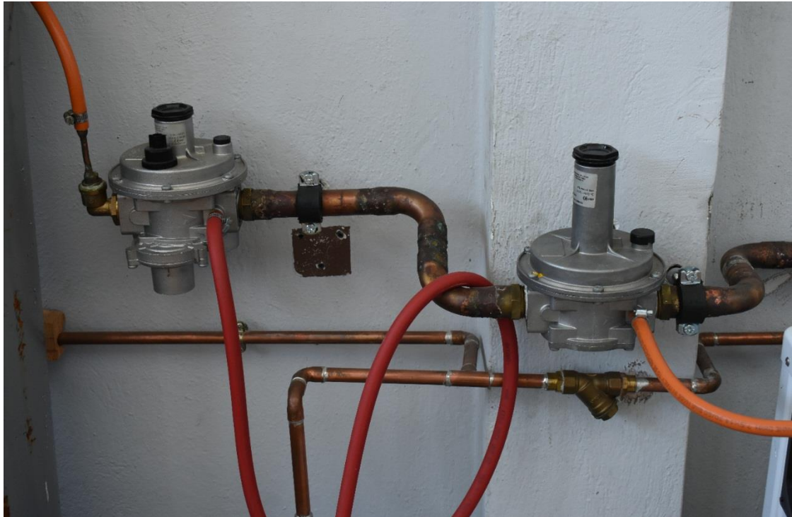
Εικόνα 23:Εγκατάσταση εργαστηρίου, μειωτές πίεσης του καυσίμου στην παροχή του συστήματος
