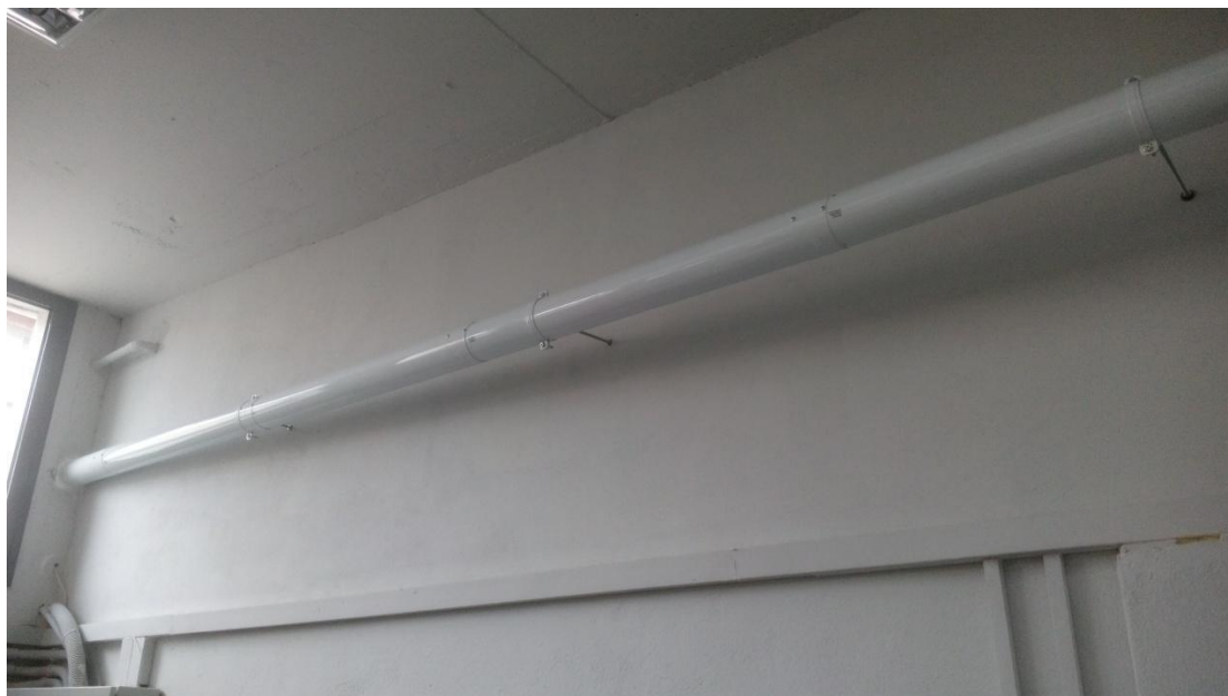
Εικόνα 19: Εγκατάσταση εργαστηρίου, σωλήνας εισαγωγής ατμοσφαιρικού αέρα και εξάτμισης καυσαερίων ομοαξονικού σωλήνα
