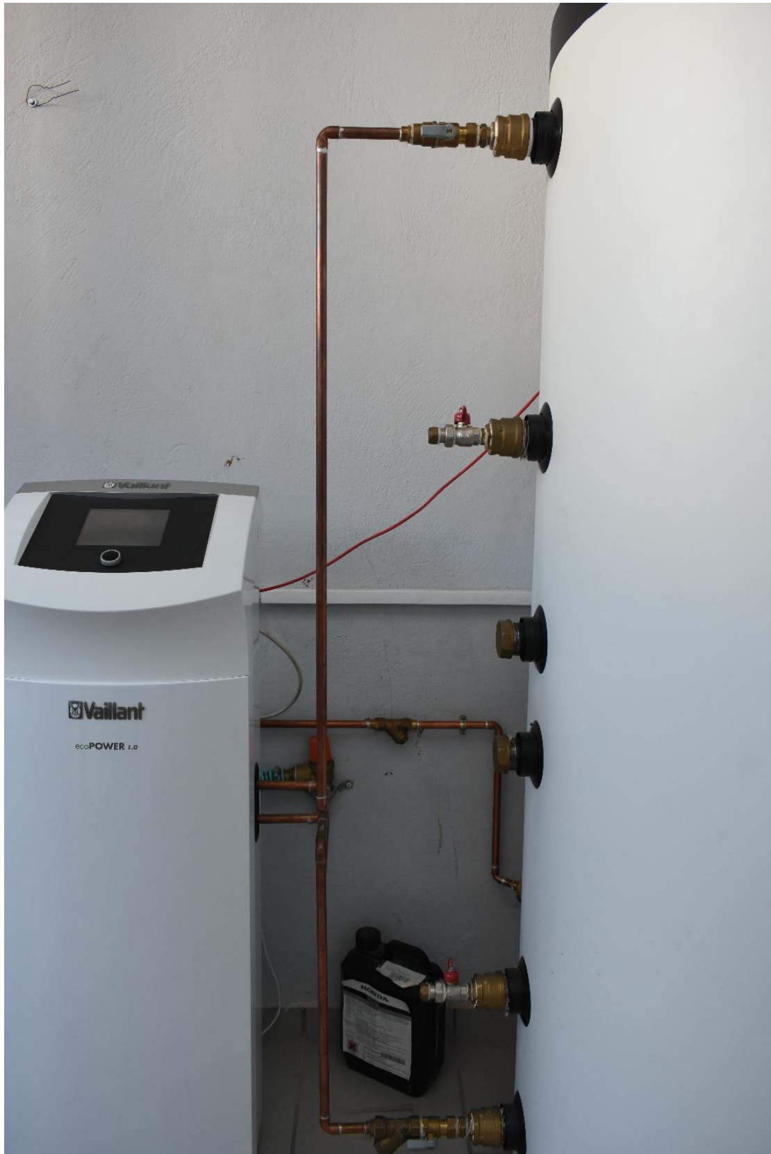
Εικόνα 16:Εγκατάσταση εργαστηρίου, σωληνώσεις στο σύστημα μεταφοράς της θερμότητας
