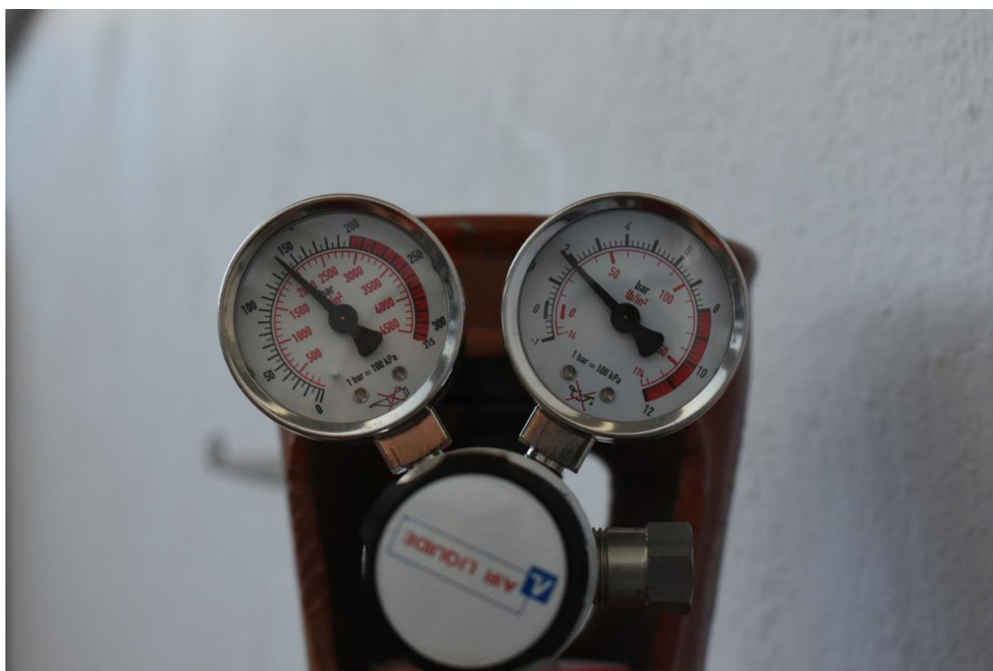
Εικόνα 22:Εγκατάσταση εργαστηρίου, δείκτες πίεσης στη φιάλη του φυσικού αερίου
