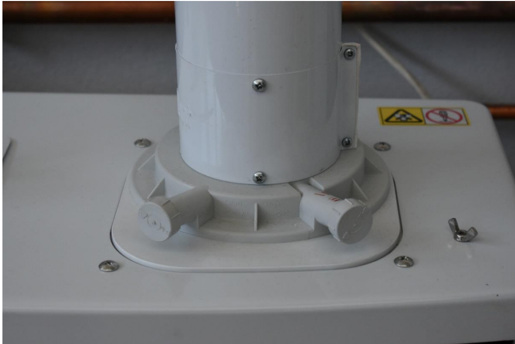
Εικόνα 20: Εγκατάσταση εργαστηρίου, σωλήνας εισαγωγής ατμοσφαιρικού αέρα και εξάτμισης καυσαερίων ομοαξονικού σωλήνα
