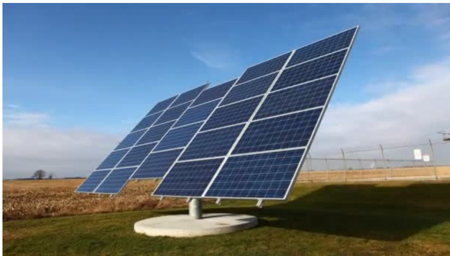
Εικόνα 2: Ηλιακό panel σε κίνηση δύο αξόνων
