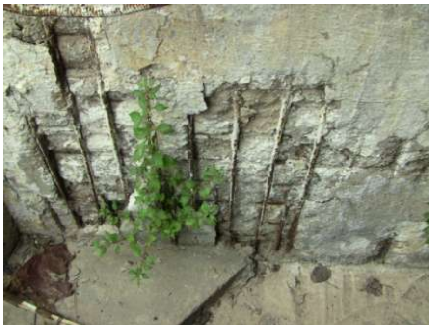
Εικόνα 2.3 Εκτίναξη επικάλυψης σκυροδέματος στο εξωτερικό τοίχιο δεξαμενής λόγω διάβρωσης του οπλισμού.
