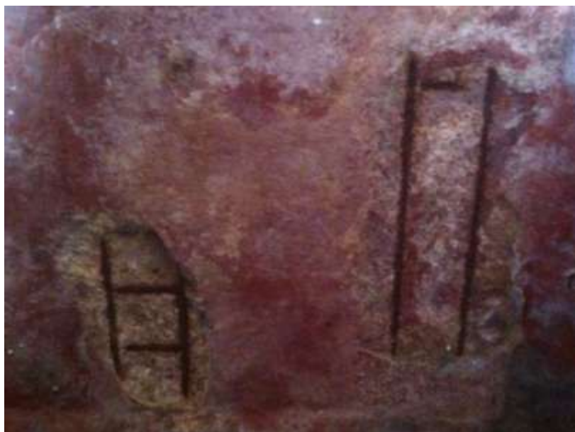
Εικόνα 3.8 Αποκάλυψη οπλισμών στην πλάκα στέγασης δεξαμενής Ω/Σ.
