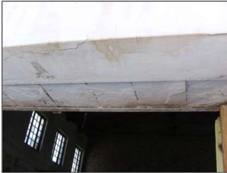
Εικόνα 2.4 Ανώφλι κυρίας εισόδου στη Δυτική όψη του συγκροτήματος. Διπλό ΙΡΕ 140 με σχιστόπλακες. Είναι εμφανής ο αποχρωματισμός του χάλυβα λόγω οξειδωσης.
