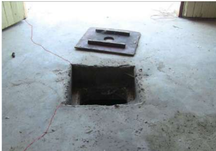
Εικόνα 2.9 Ρηγματώσεις στα δάπεδο σκυροδέματος του πατητηριού.
