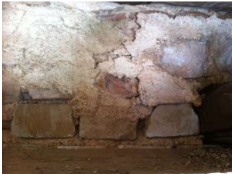
Εικόνα 3.11 Τοιχοπήρωση με φυσικά και τεχνητά τοιχοσώματα ανάμεσα στα ξύλινα ζευκτά του πατητηριού στη στάθμη έδρασης τους. Στο κάτω μέρος της εικόνας φαίνεται η φέρουσα οπτοπλινθοδομή και η απουσία ύπαρξης οριζόντιου διαζώματος.
