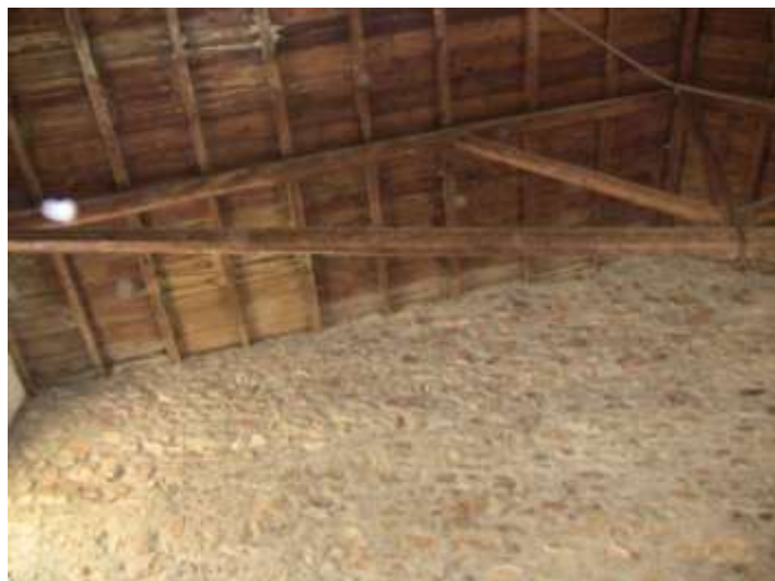
Εικόνα 2.12 Απουσία ζευκτού σε επαφή με το αέτωμα. Επίσης είναι εμφανής η απουσία διαζώματος στο αέτωμα. Διακρίνονται οι φάσεις κατασκευής της λιθοδομής.
