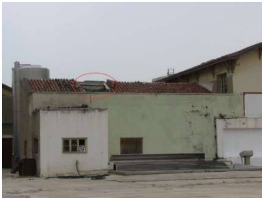
Εικόνα 2.13 Μερική κατάρρευση της μονόριχτης στέγης του παλαιού μηχανοστασίου.
