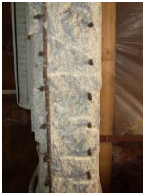
Εικόνα 3.7 Εσωτερικό Τοιχίο Ω/Σ. Στην αριστερή παρειά του είναι εμφανής η πατητή τσιμεντοκονία αδιαβροχοποίησης.
