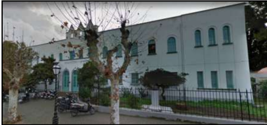
Εικόνα 5-2 Βόρεια Όψη Ιπποκράτειο Λύκειο, επί της Λεωφόρου Ιπποκράτους, Κως. Το αέτωμα της κύριας όψης υπέστη βλάβες λόγω εκτός επιπέδου καμπτικής δράσης χωρίς να καταρρεύσει.
