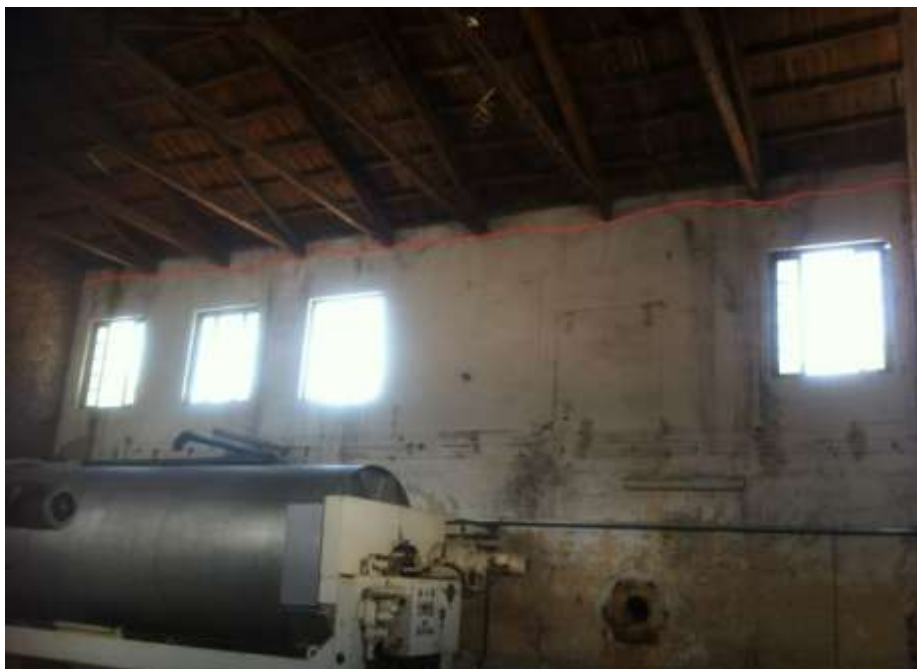
Εικόνα 2.7 Οριζόντια ρωγή στην μπατική οπτοπλινθοδομή του πατητηριού στη στάθμη στήριξης των ζευκτών.
