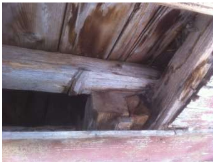
Εικόνα 2.11 Αποχρωματισμός ξύλινων μελών στέγης λόγω σήψης.
