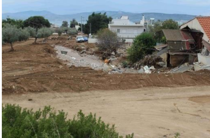
Εικόνα 30: Εικόνα από κατεστραμμένη οικία στην περιοχή της Νέας Περάμου (Αποστολίδης κ.α., 2017).
