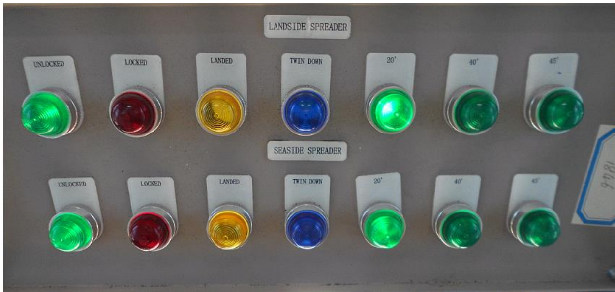
Εικόνα 29: Πίνακας ένδειξης κατάστασης Spreader
