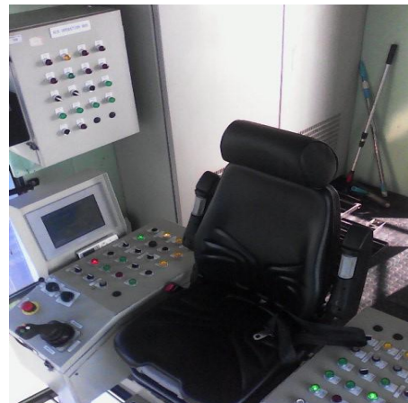
Εικόνα 19: κονσόλα χειρισμού γερανογέφυρας
