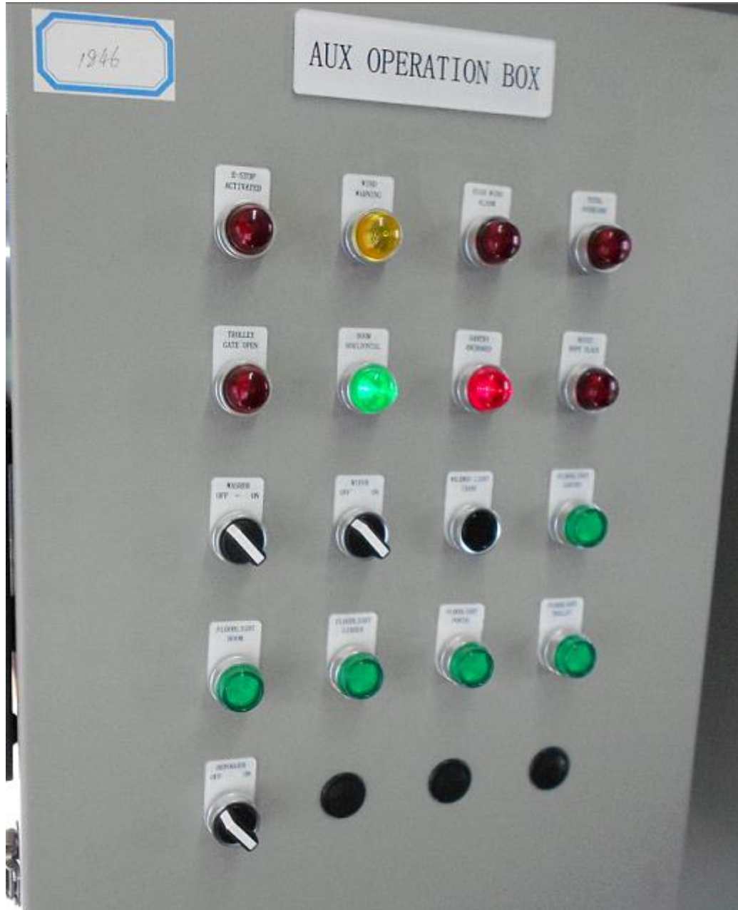
Εικόνα 28: Βοηθητικός πίνακας ελέγχου
