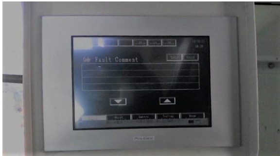
Εικόνα 20: οθόνη ενδείξεων γερανογέφυρας
