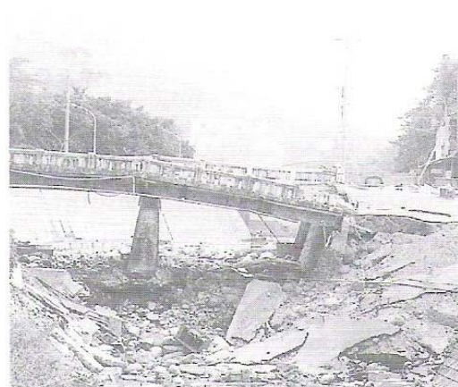
Αστοχία ακρόβαθρου λόγω ρευστοποίησης εδάφους θεμελίωσης.
