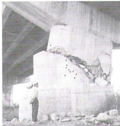
Αστοχία διατμητικού τύπου.
