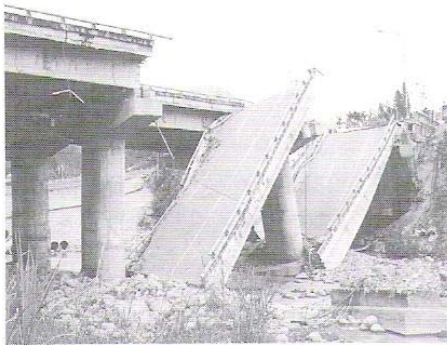
Αστοχία λόγω απώλειας στήριξης.
