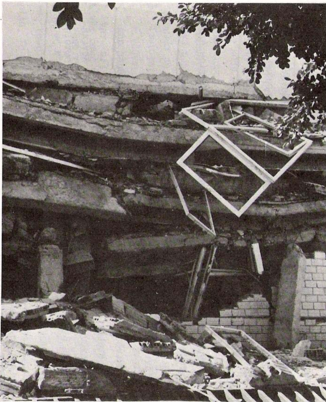
Καθολική κατάρρευση πενταώροφου κτήριου στο Ε1 Asnam
